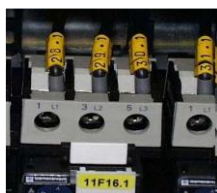
Figura 97 – Rótulos nos fios condutores
