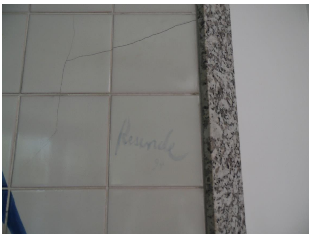
Pormenor do painel Juventude e Educação (1994) – um local da obra que está danificado
