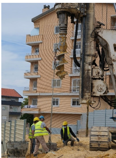
a) Escavação, com recurso a trado mecânico, dos furos para a execução das estacas espaçadas
