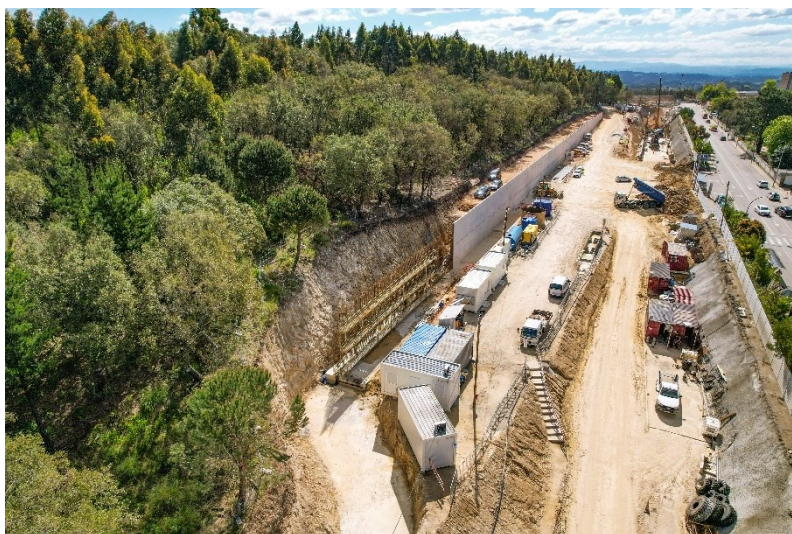
Figura 3.12 – Imagem aérea da frente de obra da Estação Hospital Santos Silva (abril 2022) [21]
