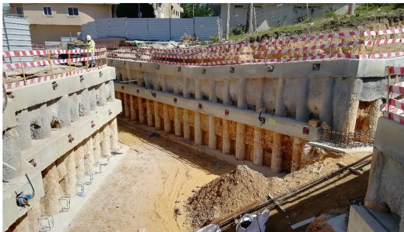
Figura 3.36 – Paragem da escavação no patamar do 2º nível intermédio, para execução da viga de distribuição e colocação das ancoragens/escoras metálicas (abril 2022)
