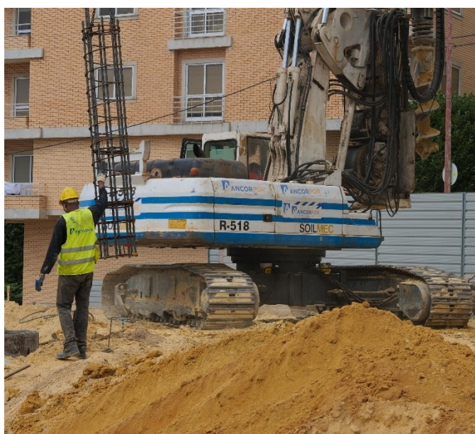
b) Colocação da armadura da estaca nos furos para posteriormente ser betonada
