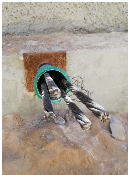
a) Ancoragens constituídas por 4 cabos de aço, cada um composto por 7 fios
