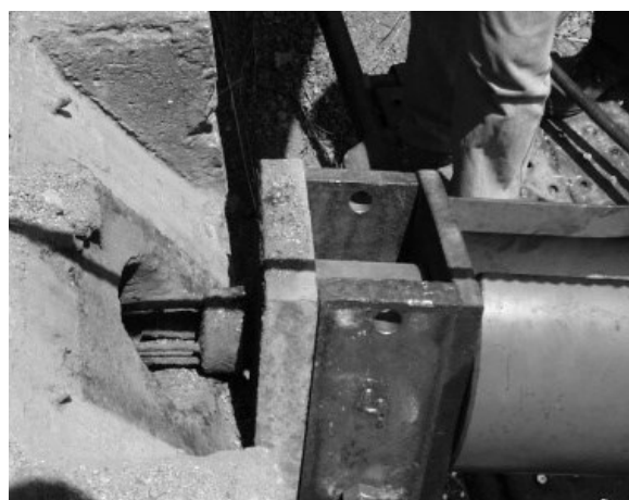
b) Rotura do elemento durante ensaio de verificação, devido à corrosão dos materiais
