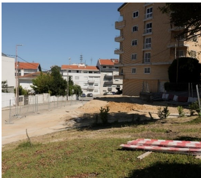
a) Zona da implantação da Galeria de Acesso Norte, antes do início dos trabalhos (agosto 2021)
