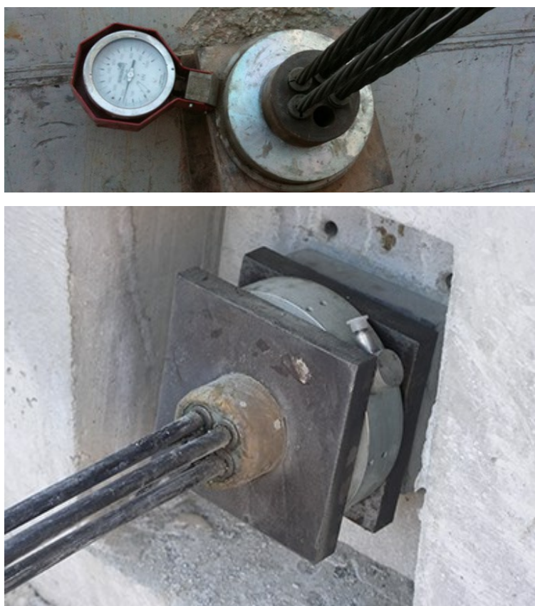
Figura 2.27 – Células de carga instaladas em ancoragens com sistema de observação direta (imagem superior) [19] e por transmissão remota de dados (imagem inferior) [27]
