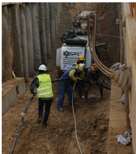
Figura 2.22 – Colocação dos cabos de aço da ancoragem no interior do furo da viga de distribuição [21]
