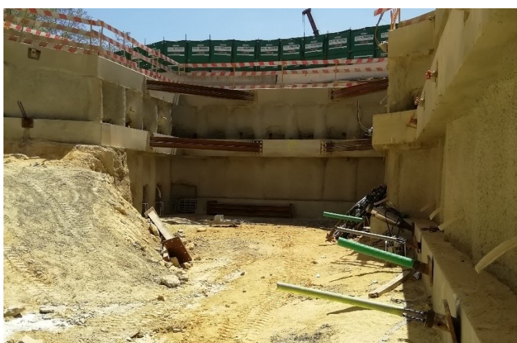
Figura 3.24 – Betonagem da cortina de estacas entre vigas de distribuição, garantindo a selagem do terreno (abril 2022) [21]
