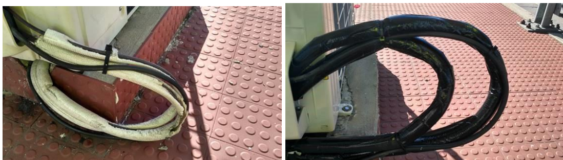
Figura 60 Conduitas AC antes (esquerda) e após (direita) intervenção de isolamento de tubagens
