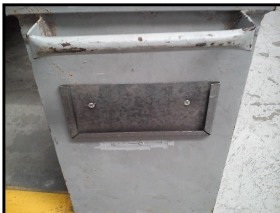
FIGURA 49 - CAIXA COM CHAPA METÁLICA ONDE IRÃO FICAR AS IDENTIFICAÇÕES
