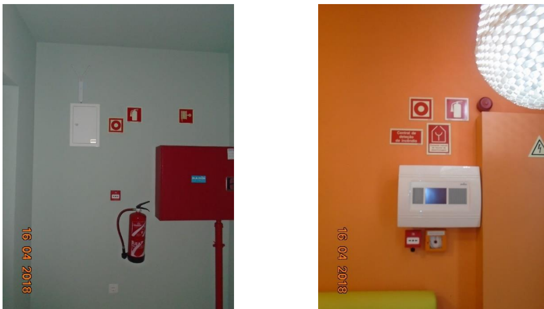
Figura 3.41 – Instalações de segurança contra incêndios.
