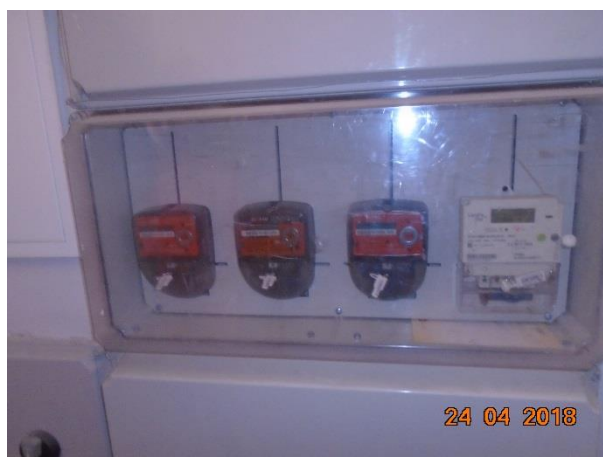
b) Contadores elétricos.
