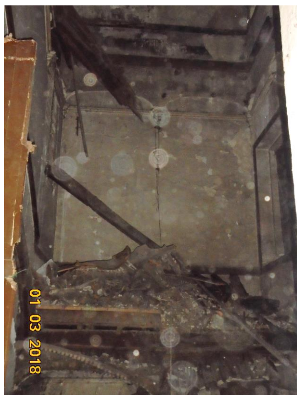
b) Escadas em ruína.
