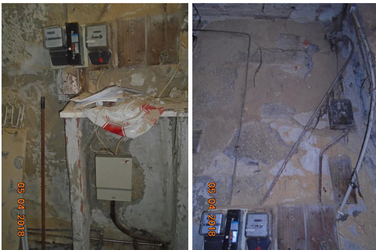
a) Não existe armário de contadores.
