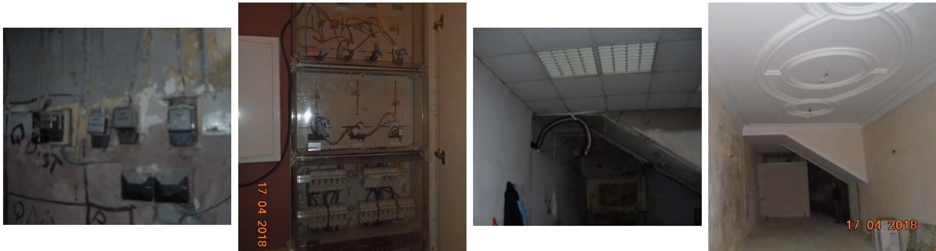
a) Quadro elétrico – antes/após a reabilitação.
