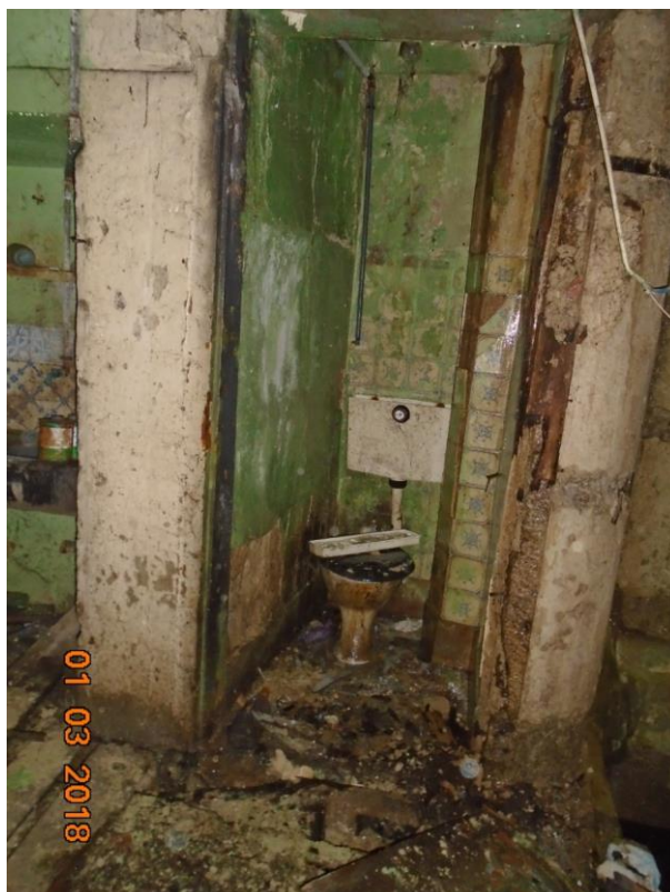
Figura 3.14 – Ilustração das anomalias do elemento funcional instalação de distribuição de água e instalação de drenagem de águas residuais.
