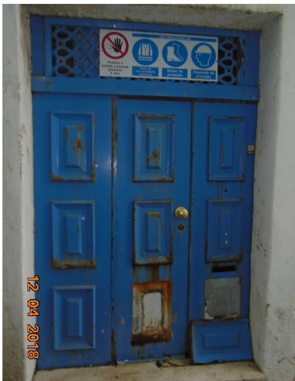
a) Porta com revestimento degradado e sinais de corrosão.
