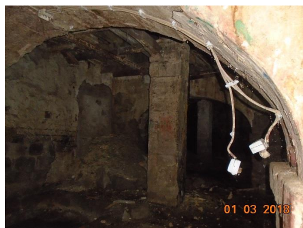
b) Aparelhagem elétrica inoperacional
