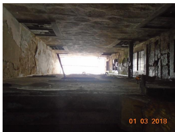
b) Elementos degradados devido às infiltrações.
