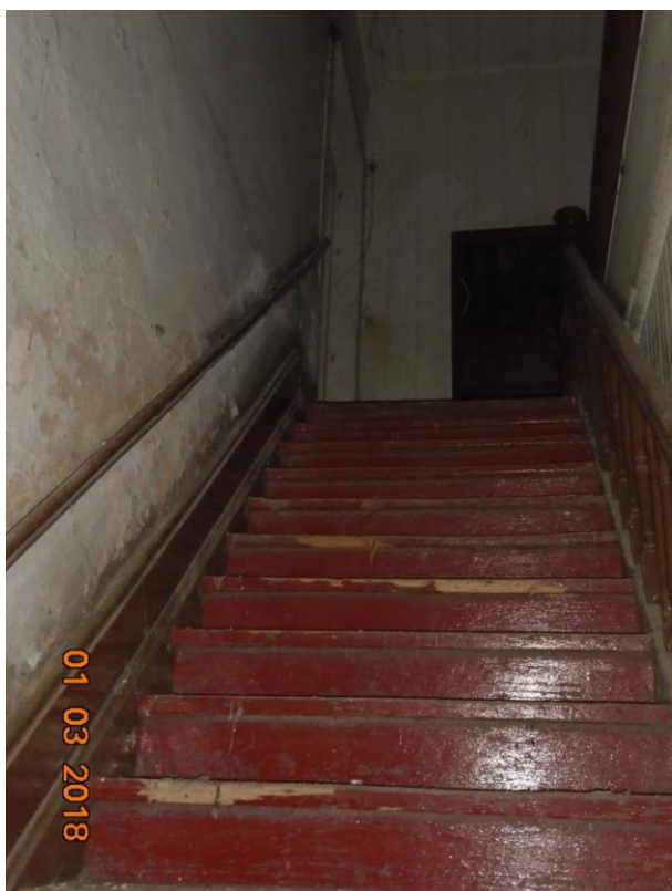
a) Escadas com desgaste acentuado.
