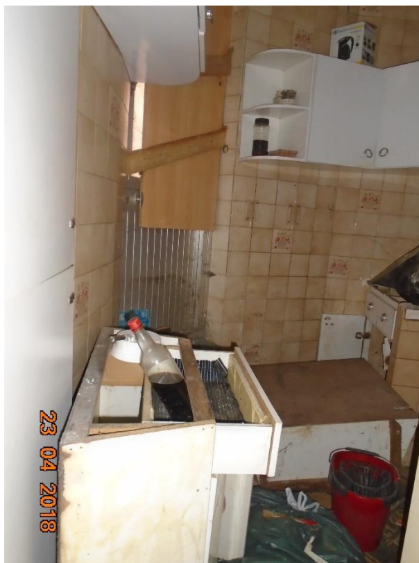
b) Ausência de equipamentos e armários sujos e deteriorados.
