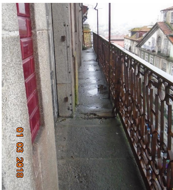
a) Pavimento da varanda com sujidades e juntas com falta de argamassa.
