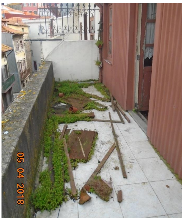
a) Murete com eflorescências generalizadas.
