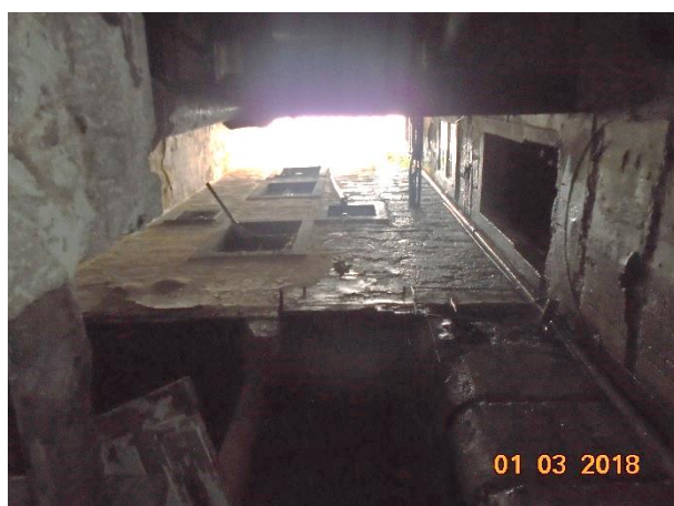
a) Infiltrações provenientes da cobertura.
