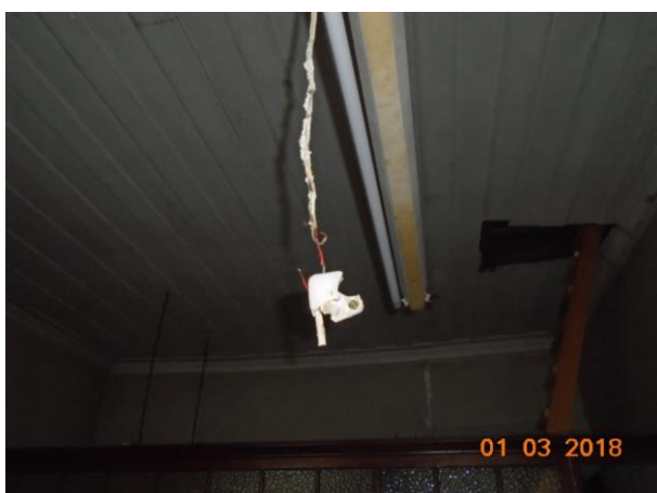
a) Aparelhagem elétrica inoperacional.
