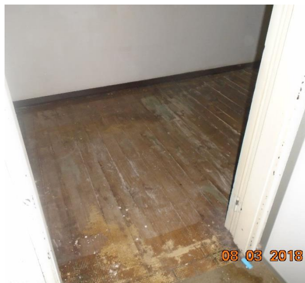
b) Soalho com sujidade e desgaste acentuado.
