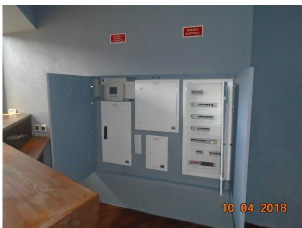
a) Quadros elétricos.
