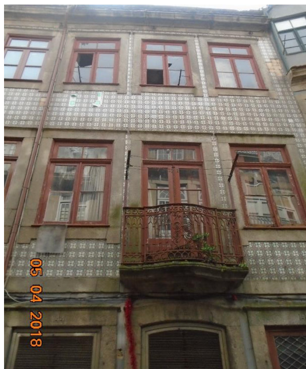
b) Guarda metálica com corrosão pontual.
