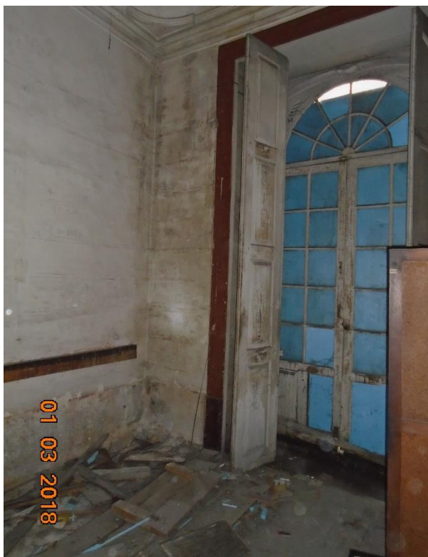
b) Janela e portadas com degradação acentuada e vidros partidos.
