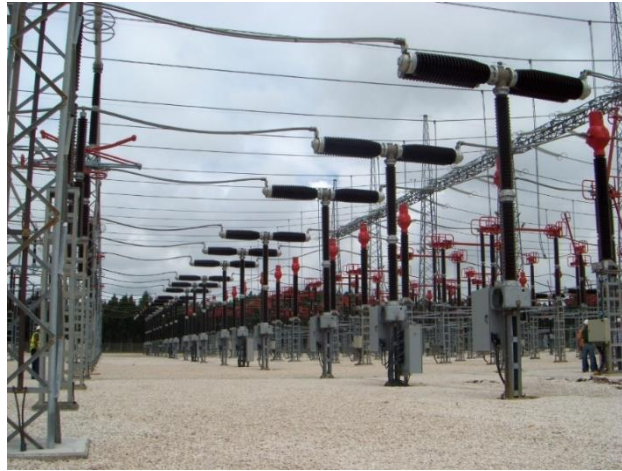
Figura 15- Subestação de Lavos
