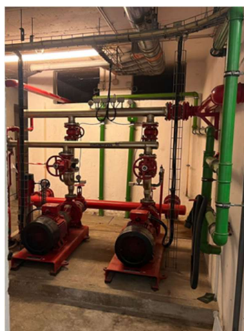
Figura 10 - Central de bombagem instalada no Piso -1
