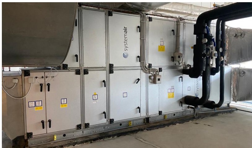
Figura 19 - Unidade de Tratamento de Ar
