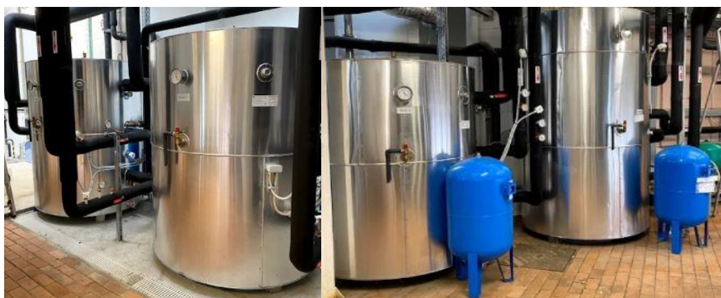
Figura 30 - Depósitos de Águas Quentes
