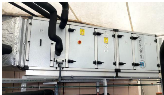
Figura 21 - Unidade de Tratamento de Ar Novo
