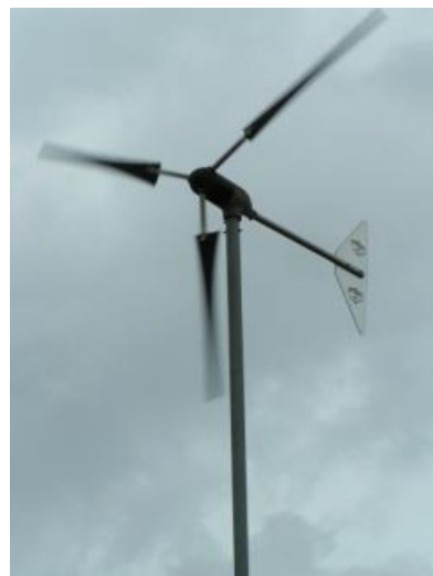
b) Sistema eólico do edifício F
