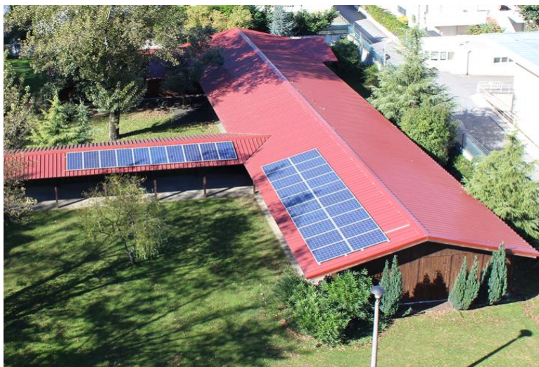
a) Sistema fotovoltaico do edifício N
