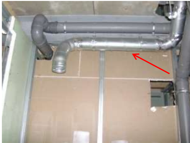
Figura 62- Tubagens de ventilação
