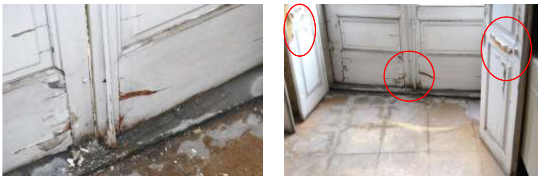
Figura 83- Portas interiores com revestimento degradado e sinais de apodrecimento
