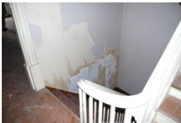
Figura 80- Descolamento do revestimento na parede da caixa de escada
