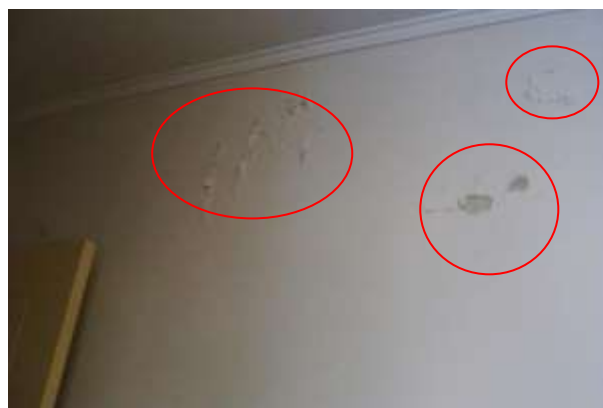
Figura 78- Destacamento da pintura da parede interior
