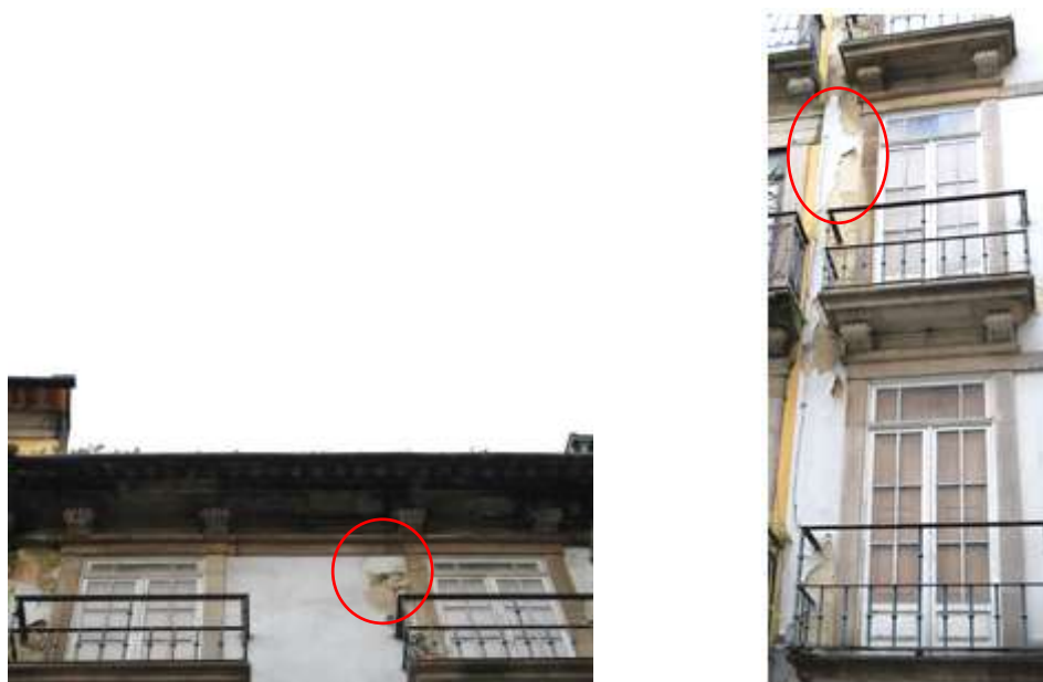
Figura 77- Destacamento do revestimento das paredes exteriores
