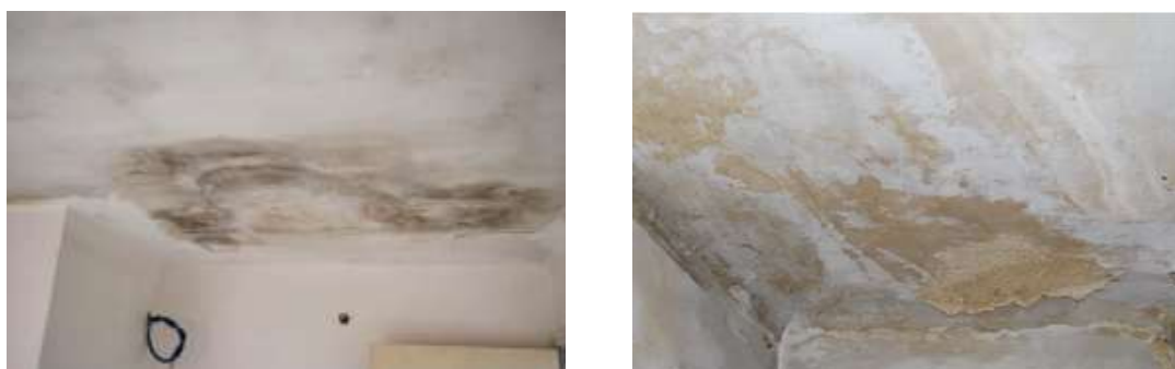
Figura 81- Manchas de humidade e destacamento do revestimento no teto
