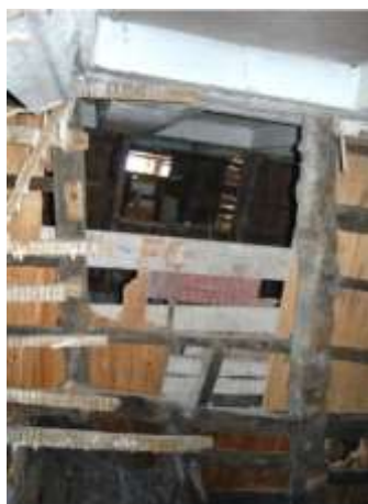
Figura 72- Aberturas nos tetos degradados
