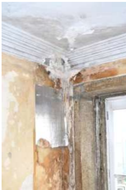
Figura 79- Degradação da parede interior
