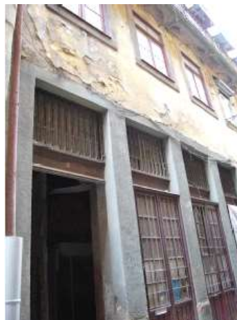
Figura 75- Paredes exteriores bastante degradadas
