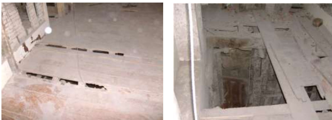
Figura 71- Revestimento de piso inexistente
