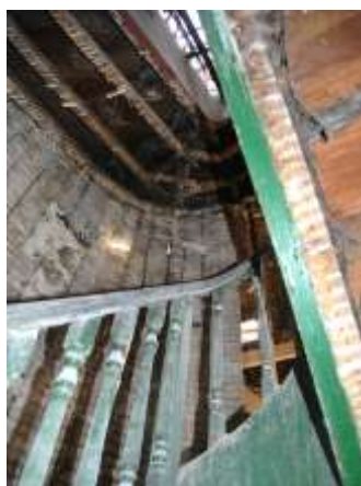
Figura 76- Escadas indicando risco de colapso
