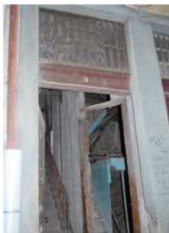
Figura 73- Caixilharias e porta exterior deterioradas
