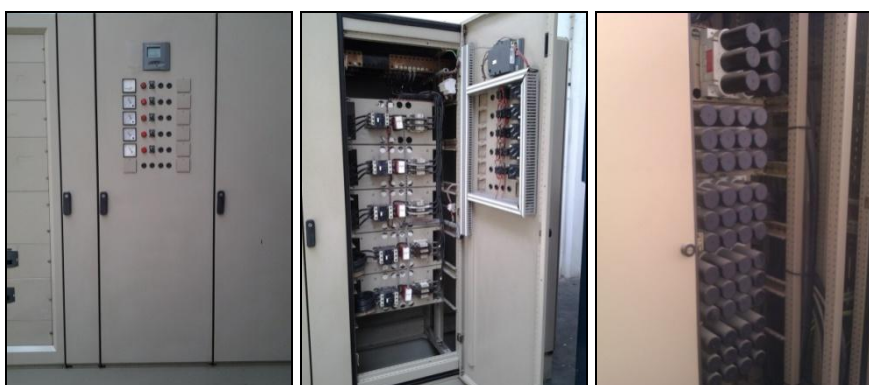
Figura 2.1 - Demonstração da bateria de condensadores automática da ABB existente
