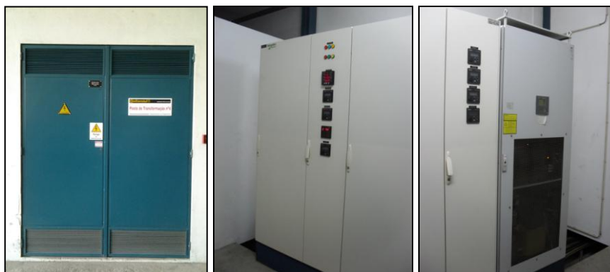
Figura 1.29 - Vista exterior e interior do QGBT do PT 4
