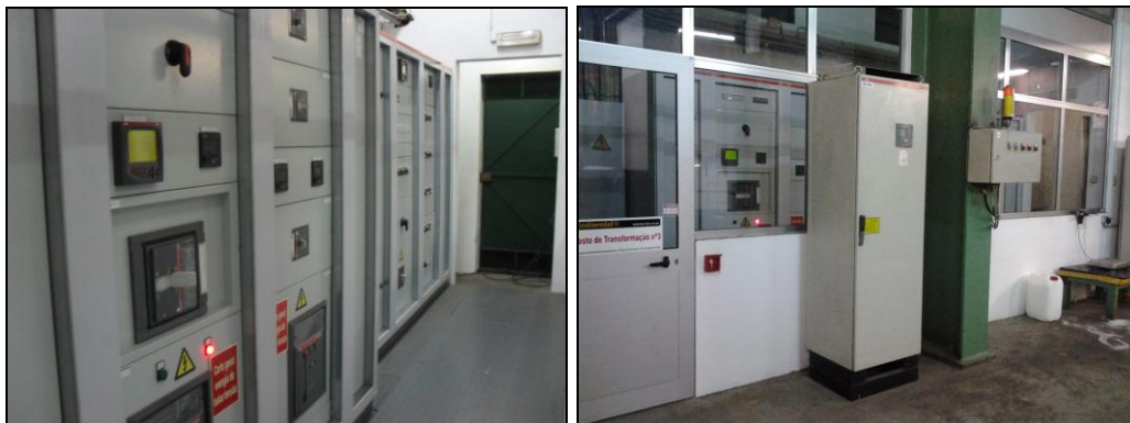
Figura 1.28 - Vista do QGBT e bateria de condensadores do PT 3
