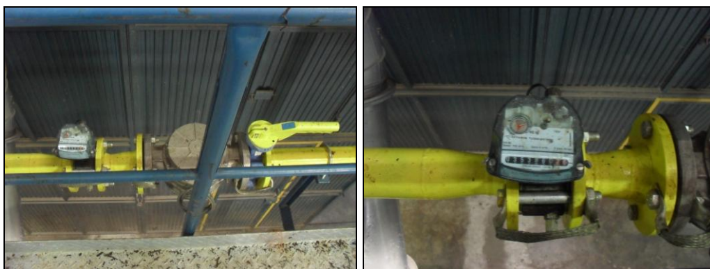
Figura 3.30 - Medidor de gás Activar referente ao consumo pela SE
