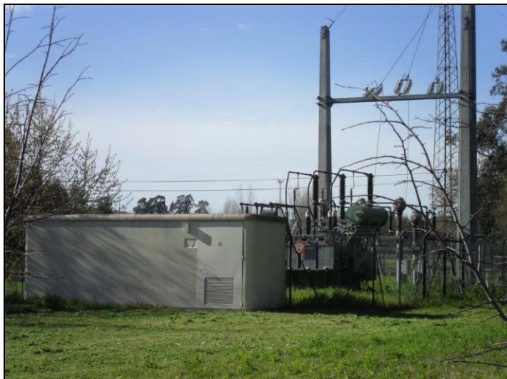
Figura 1.26 - Vista da subestação
