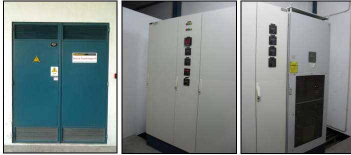
Figura 3.19 - Demonstração do exterior do PT4 (à esquerda) e do QGBT com analisadores de energia embutidos (ao centro e à direita)
