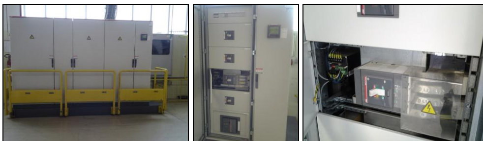
Figura 3.18 - Demonstração do QE 008 e terminal do analisador de energia
