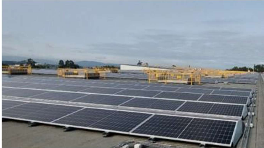
Figura 46- Central Fotovoltaica com 32140 painéis solares (9,96 MW) - cobertura estacionamento.
