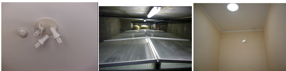
Figura 5. 1 – Exemplos de iluminação encontrada no edifício
