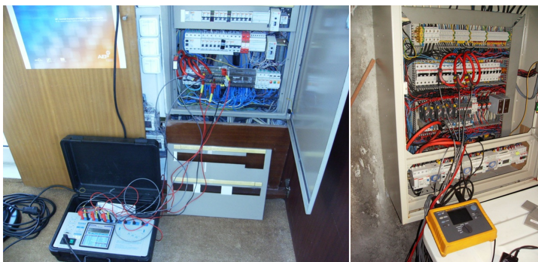
Figura 5. 5 – Medidores de energia colocados em medição nos quadros eléctricos
