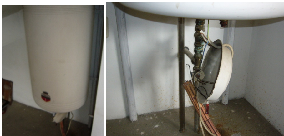
Figura 3. 15 – Termoacumulador desactivado das águas furtadas
