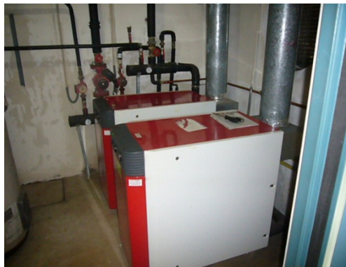
Figura 3. 13 – Caldeiras a gás natural
