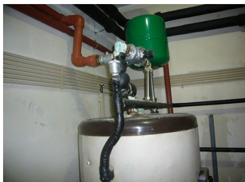
Figura 3. 14 – Depósito de acumulação de água quente sanitária
