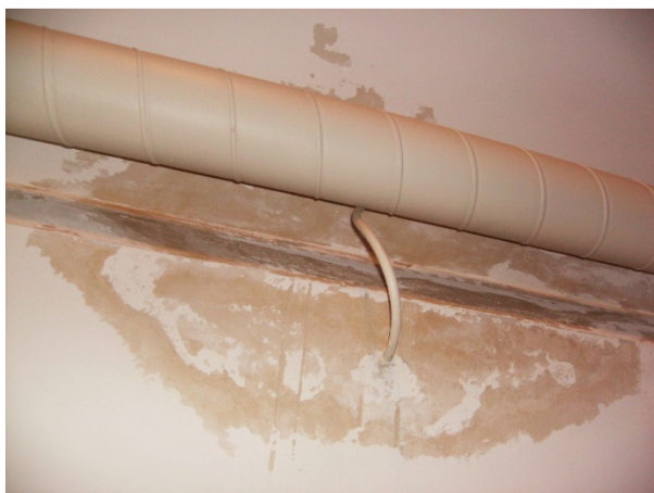
Figura 4. 11 – Problemas de humidade por infiltração no Vestiário das Senhoras
