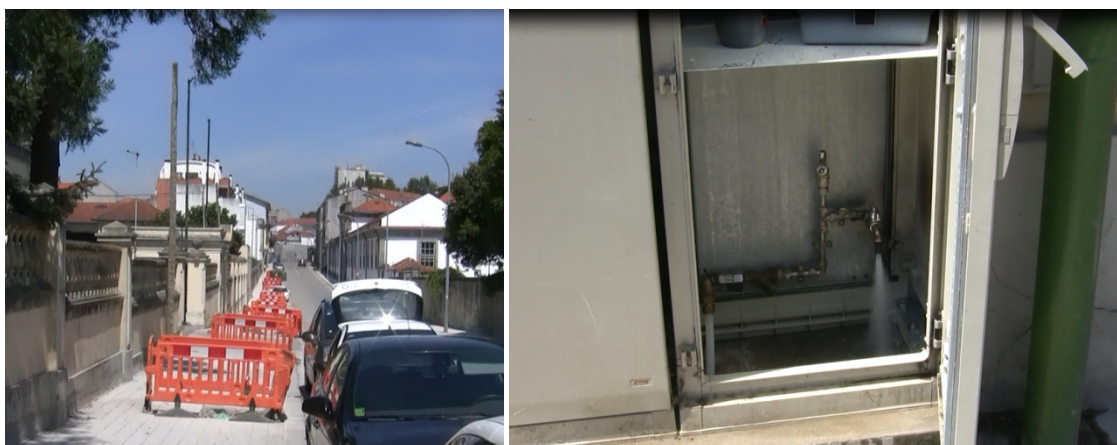
Figura 2.4 Visão do ponto de recolha para análise do PA352, final da conduta de Jovim
