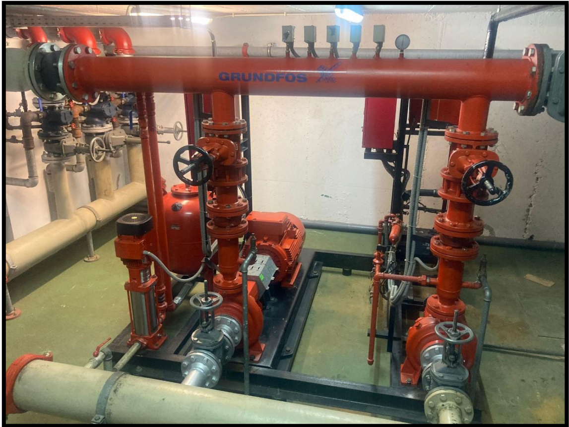
Figura 11 - Bombas de central de sprinklers hotel, vistas de frente
