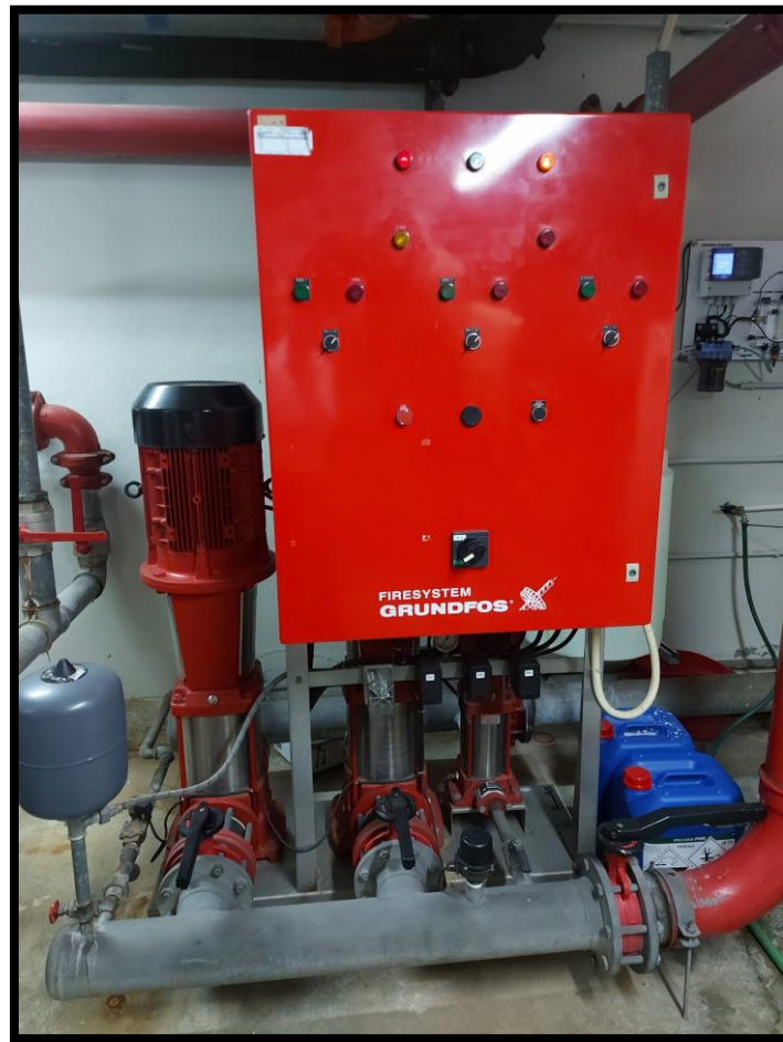
Figura 14 - Aspeto geral da central de carreteis hotel
