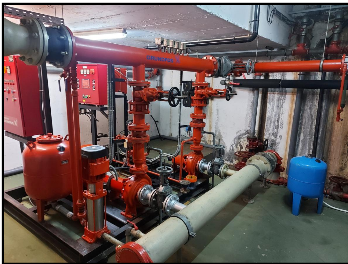
Figura 10 - Aspeto geral da central de sprinklers hotel
