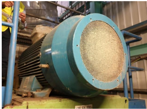
Figura 15 Motor do ventilador de ar secundário.
