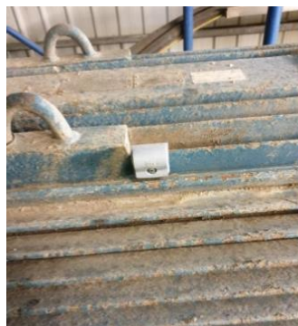
Figura 19 Instalação do sensor Motor Scan no motor da CR4
