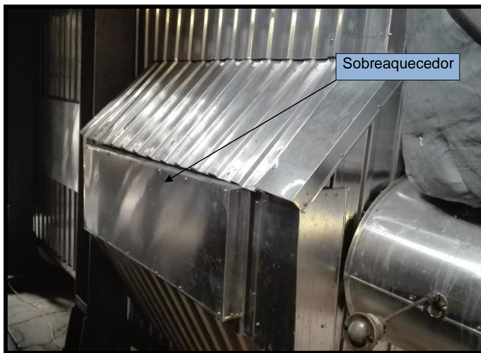
Figura 3.1 Sobreaquecedor da caldeira nº 2 da RAR Cogeração
