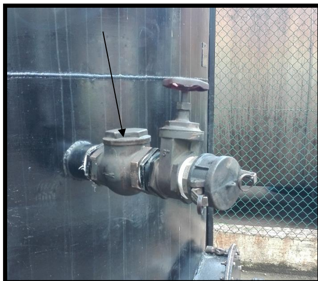
Figura 3.37 Válvula de retorno instalada na alimentação do reservatório
