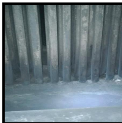
Figura 3.26 Economizador da caldeira nº 2 depois da limpeza
