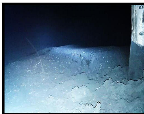
Figura 3.28 Chaminé das caldeiras 2 e 3 antes da limpeza (2)
