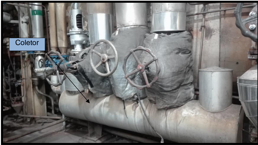
Figura 3.9 Coletor de baixa pressão da RAR Cogeração
