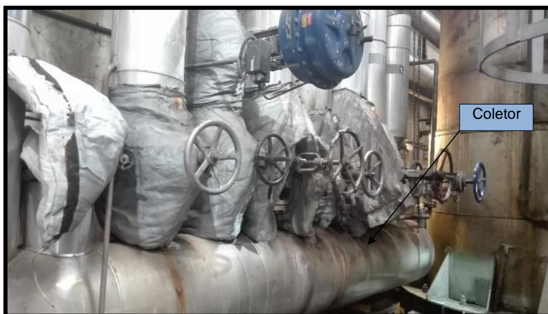
Figura 3.8. Coletor de alta pressão da RAR Cogeração
