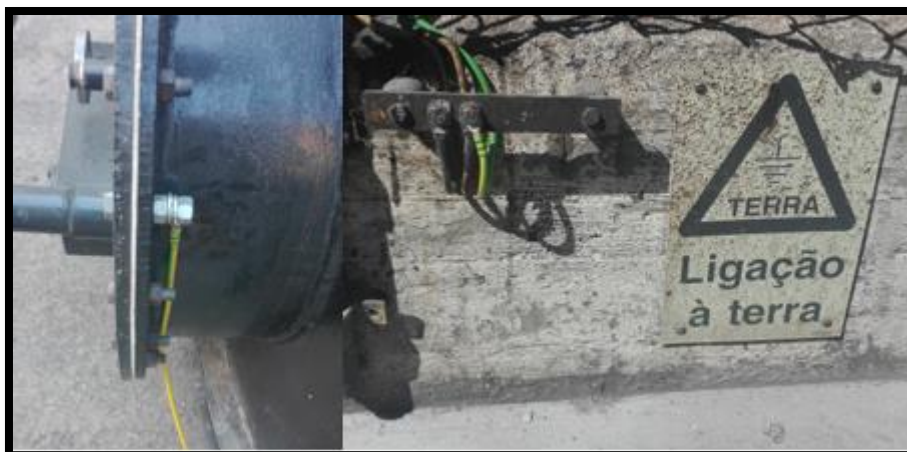
Figura 3.39 Ligação à Terra (depósito do combustível novo)
