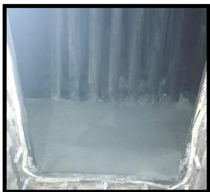
Figura 3.25 Economizador da caldeira nº 2 antes da limpeza
