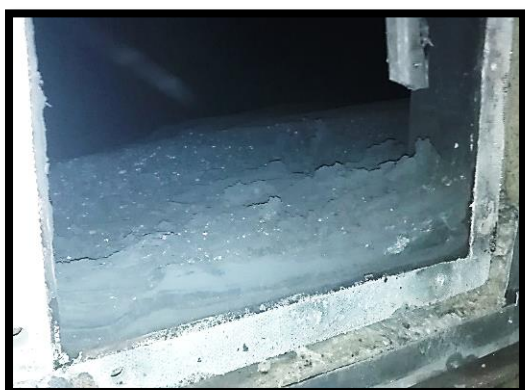
Figura 3.27 Chaminé das caldeiras 2 e 3 antes da limpeza (1)
