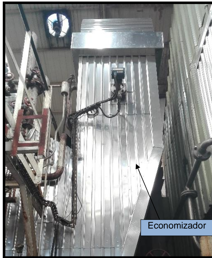
Figura 3.2 Economizador da Caldeira nº2 da RAR Cogeração
