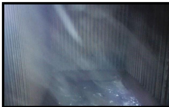
Figura 3.24 Interior da caldeira nº 2 depois da limpeza (dificuldade devido ao pó e pouca luz)
