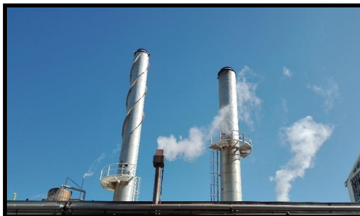
Figura 2.10 Chaminés correspondentes às caldeiras da RAR Cogeração
