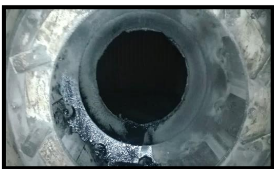
Figura 3.19 Abertura da caldeira nº 2 antes da limpeza
