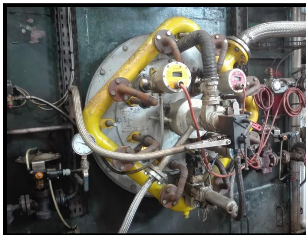
Figura 2.6 Queimador misto (fotografia tirada ao queimador da caldeira nº 1)
