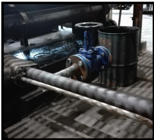
Figura 3.33 Tubagem (antes da ligação à caldeira) com válvula globo instalada
