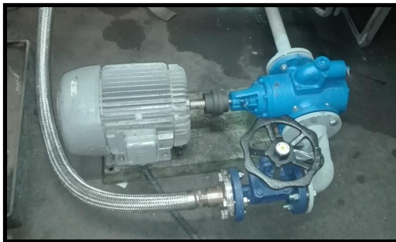
Figura 3. 32 Bomba e Válvula globo utilizadas para o percurso de passagem do fuelóleo nº 3
