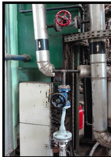
Figura 3.36 Tubagem com válvula globo para o retorno do fuelóleo nº 3 ao reservatório
