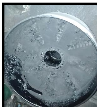
Figura 3.20 Porta da caldeira nº 2 antes da limpeza
