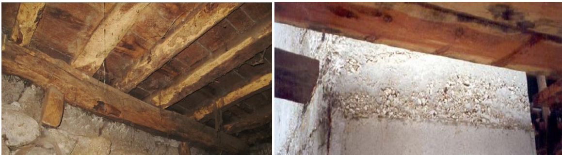
Figura 2.12 – Patologias associadas às estruturas de madeira e betão. [9] [10]
