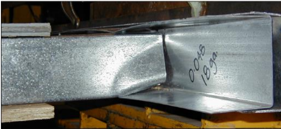
Figura 2.14 – Esmagamento da alma junto ao apoio. [6]
