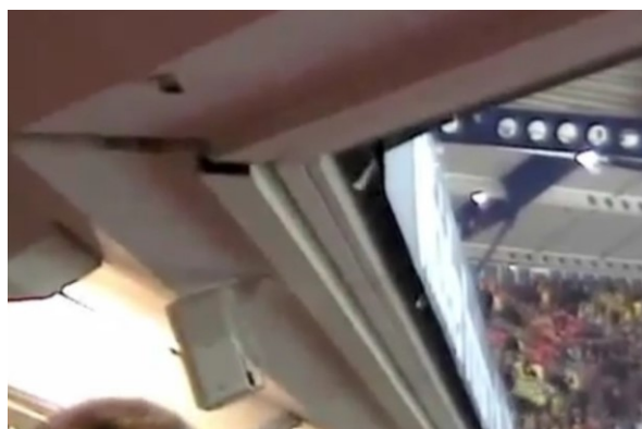
Figura 1.2 — Frankenstadion em Nuremberga – Vista inferior da bancada com deslocamentos excessivos entre os blocos de bancada (Silva, 2012).
