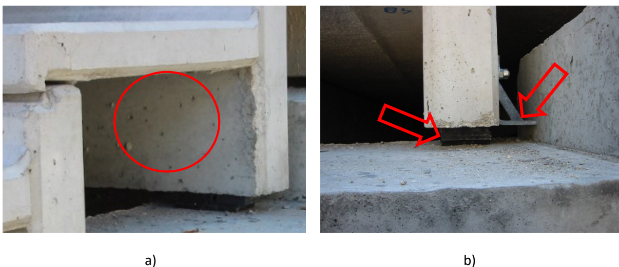
Figura 4.14 — Montagem dos degraus de bancada durante construção do Estádio do Dragão (GEG, 2002): a) porosidade elevada na nervura do degrau; b) pormenor do apoio na viga de bancada.
