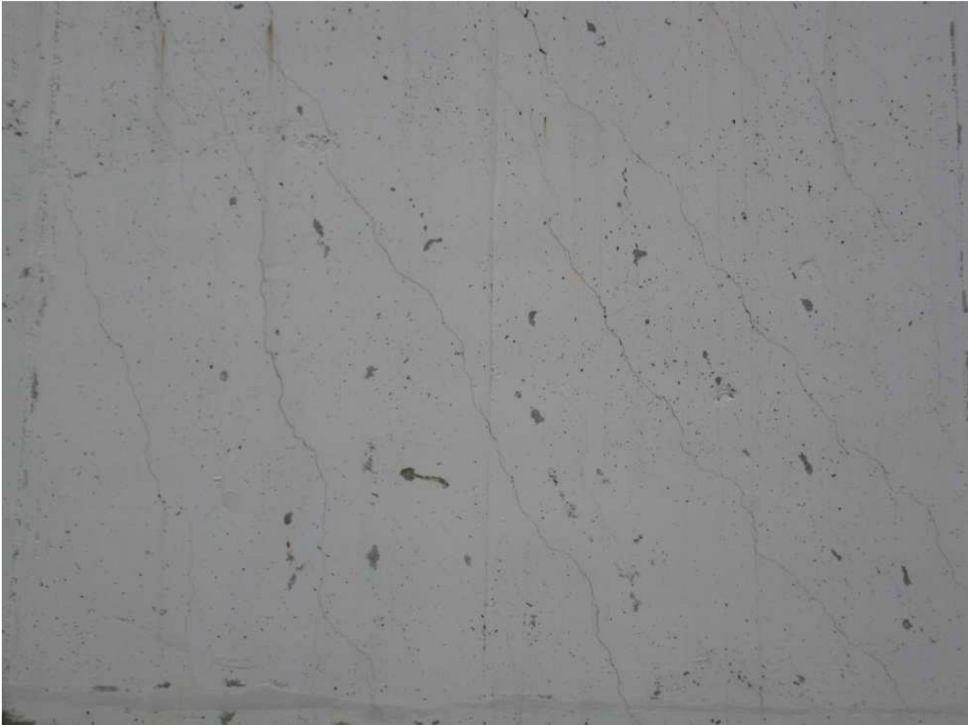
Figura 3.2: Fissuras na camada superficial do betão devido a retracção plástica.
