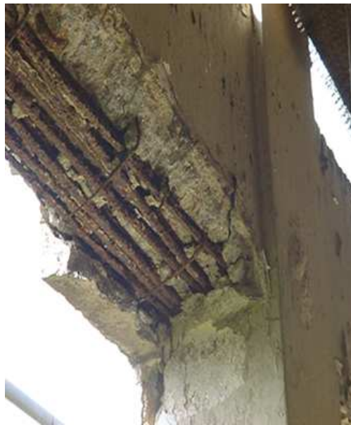
Figura 3.4: Viga com forte corrosão das armaduras após o destaque do recobrimento.
