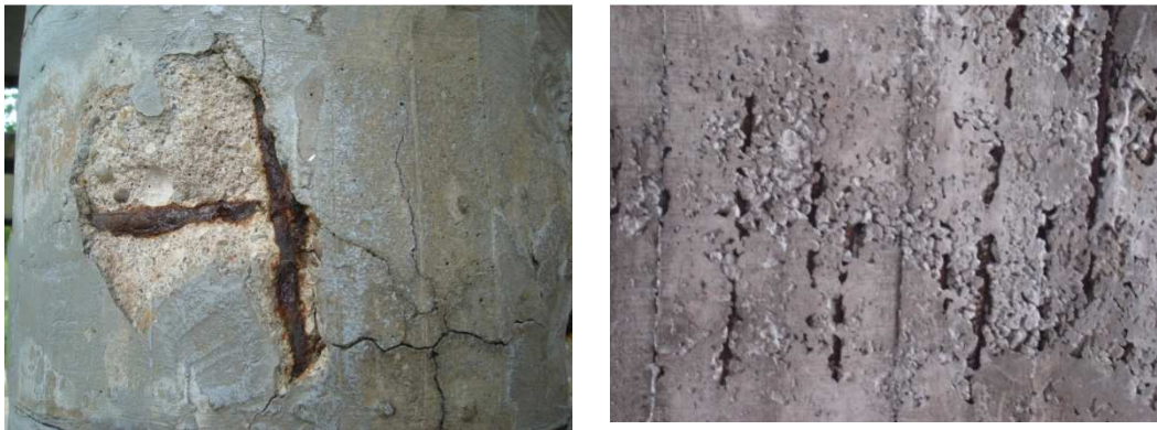
Figura 2.2: Reduzido recobrimento das armaduras.
