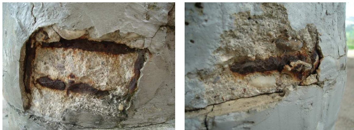
Figura 3.3: Deterioração do recobrimento do betão, e conseqüente corrosão das armaduras.
