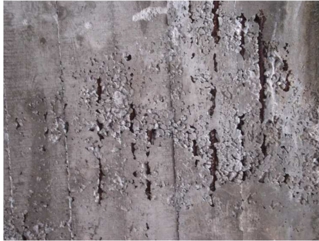
Figura 2.3: Vibração deficiente do betão.
