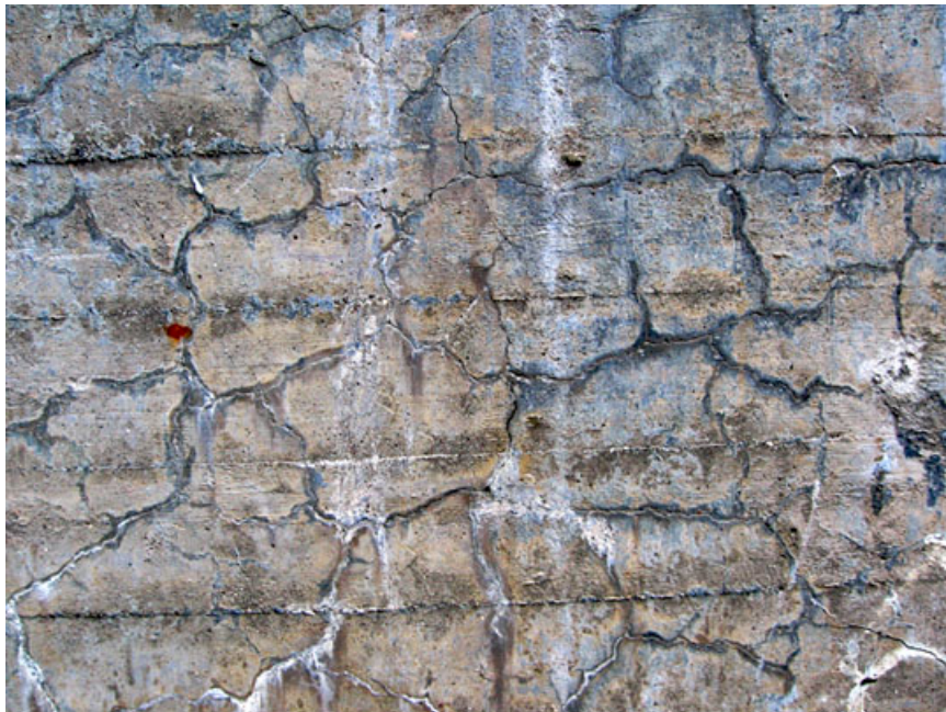
Figura 3.5: Recobrimento do betão fendilhado, com manchas causadas pela lixiviação.
