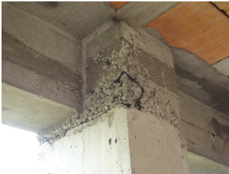
Figura 2.1: Perda de finos devido à falta de estanquidade das cofragens.
