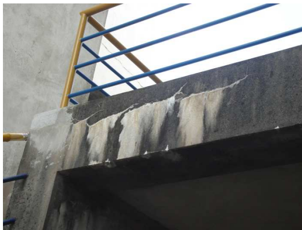
Figura 3.1: Viga de betão armado com sinais de degradação devido à fendilhação.
