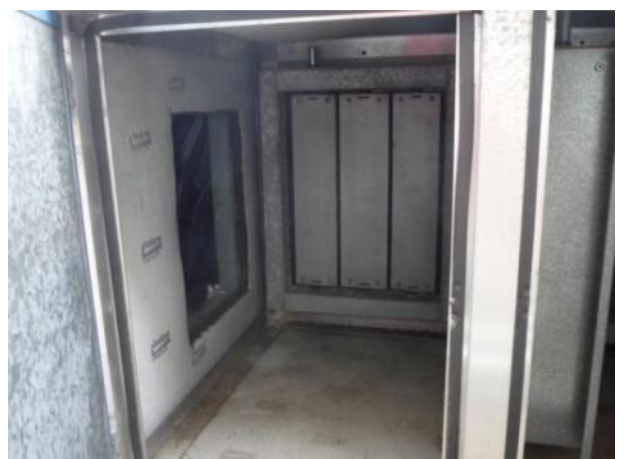
Figura H.6 – Entrada de ar (interior da UTA)
