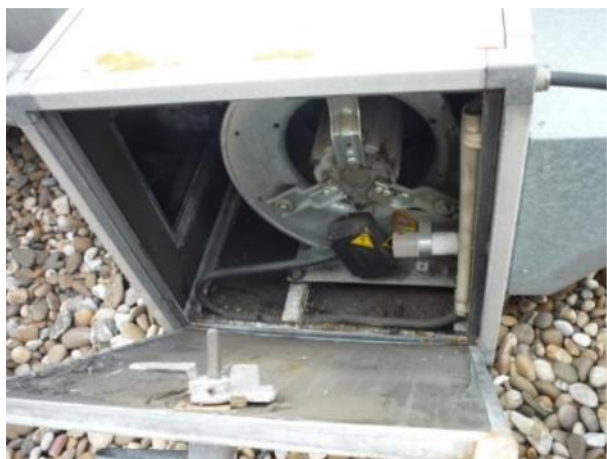
Figura H.37 - Ventilador: vista interior
