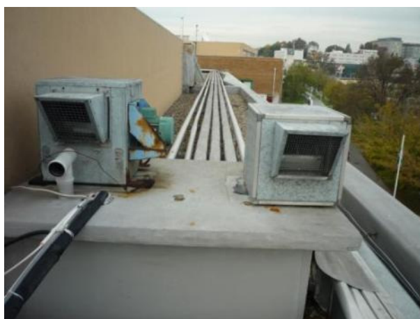
Figura H.33 - Ventiladores
