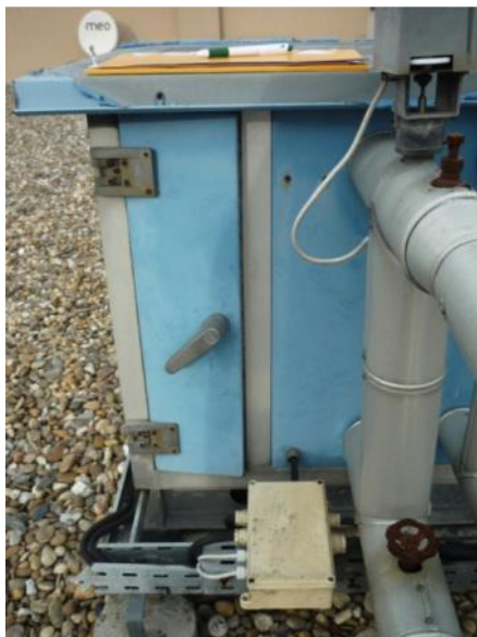
Figura H.27 - Acesso ao filtro
