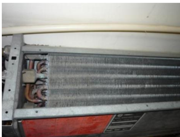
Figura H.43 - Baterias de aquecimento e arrefecimento
