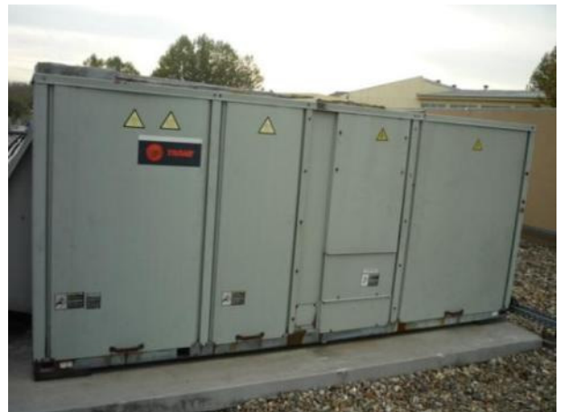
Figura H.29 – Unidade Roof-top
