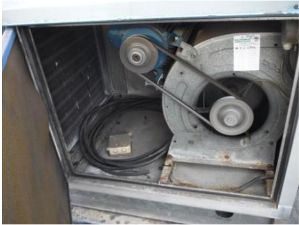
Figura H.25 - Ventilador e bateria
