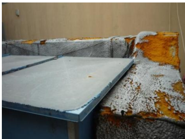
Figura H.19 - Isolamento com marcas de corrosão
