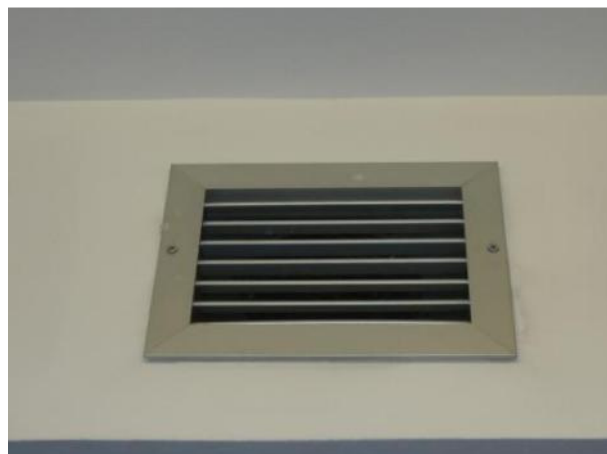
Figura H.45 - Grelha de Insuflação
