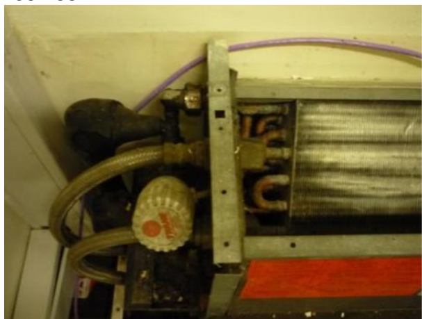
Figura H.38 - Ventilo-convector: tubos e tabuleiro de condensados
