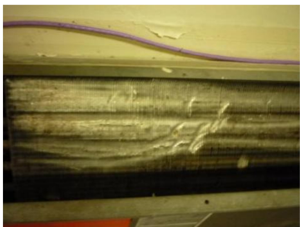
Figura H.39 - Ventilo-convector: baterias
