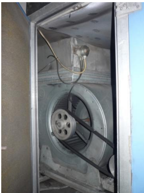
Figura H.3 - Ventilador da UTA
