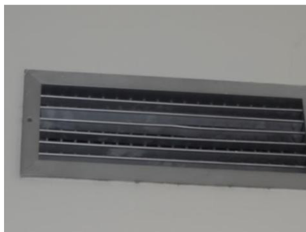
Figura H.40 - Grelha de insuflação
