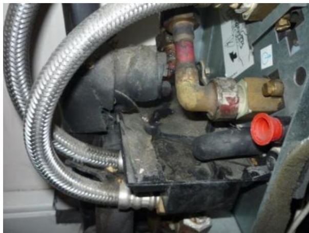
Figura H.42 - Tubos e tabuleiros de condensados
