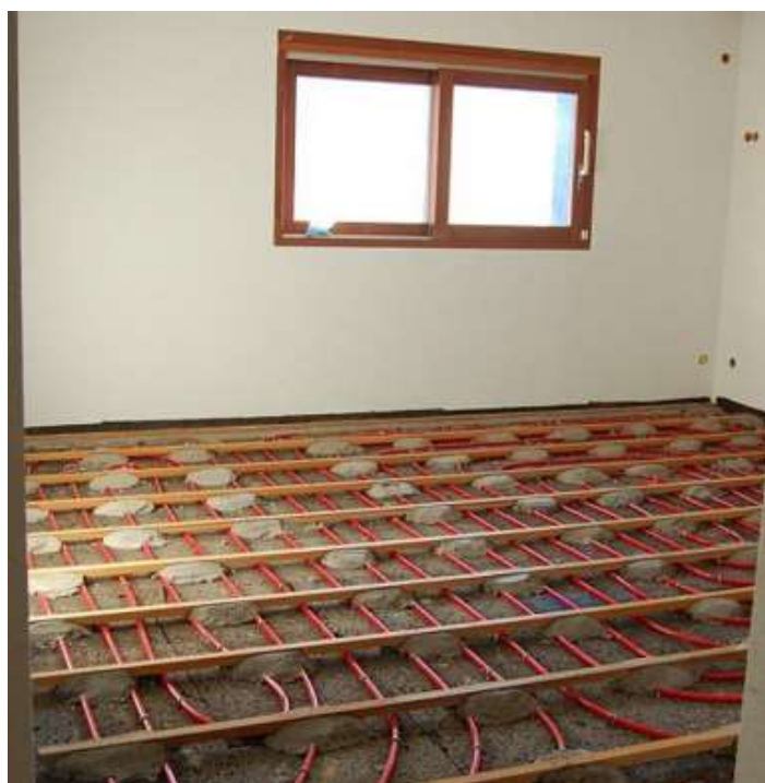
Figura 2.22 - Colocação de tubos de agua aquecida sob placas de aglomerado de cortiça.
