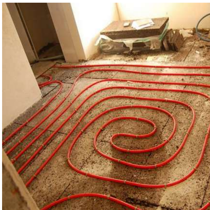
Figura 2.21 - Colocação de tubos de agua aquecida sob placas de aglomerado de cortiça.
