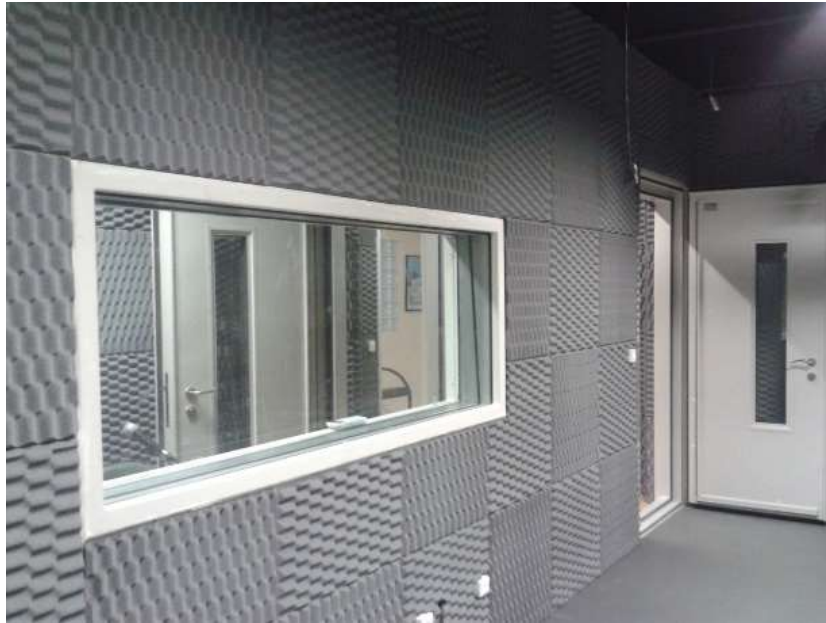
Figura 2.16 - Espuma de poliuretano para isolamento acústico de estúdios musicais.
