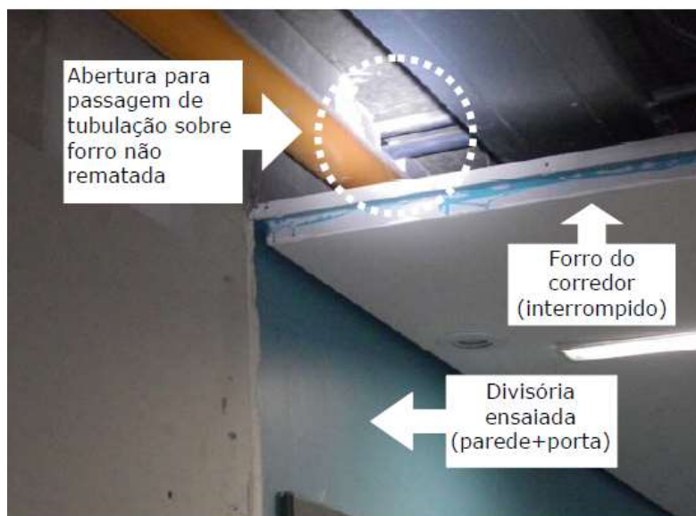
Figura 3.33 - Detalhe do forro com falha na passagem de tubulação.
