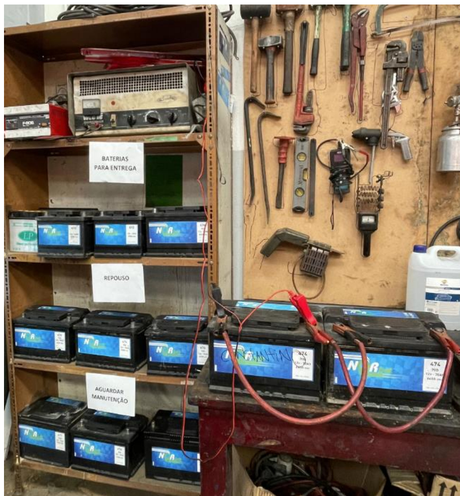
Figura 36 - Estante de manutenção de baterias
