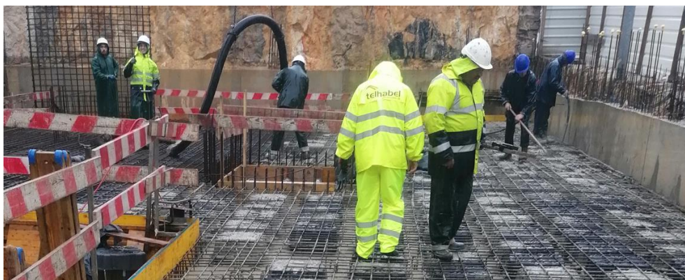
Figura 4-19 – Betonagem da 1.ª fase na lâmina inferior de uma laje fungiforme aligeirada com moldes perdidos (Extraído de: Telhabel, 2023b)
