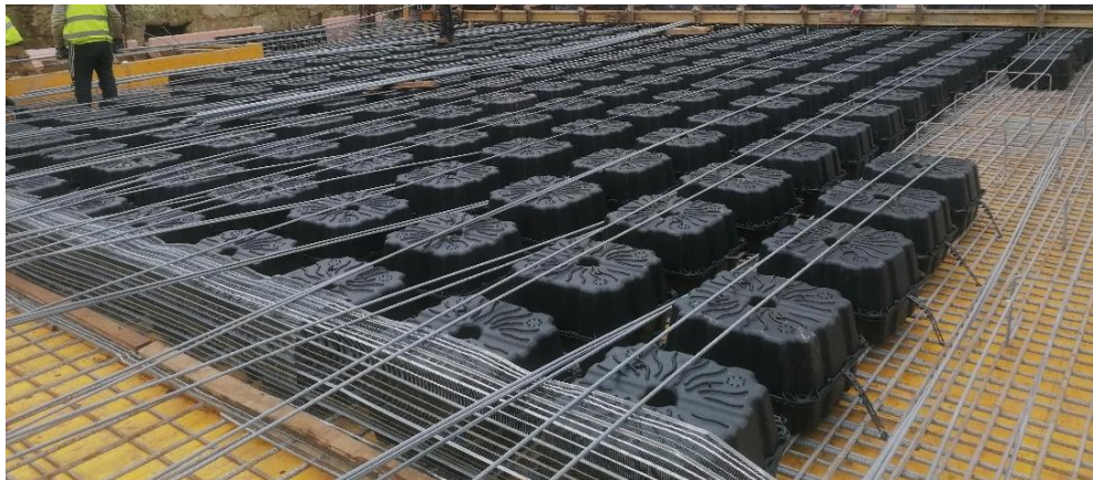
Figura 4-18 – Colocação e amarração de armaduras superiores de uma laje fungiforme aligeirada com moldes perdidos (Extraído de: Telhabel, 2023b)
