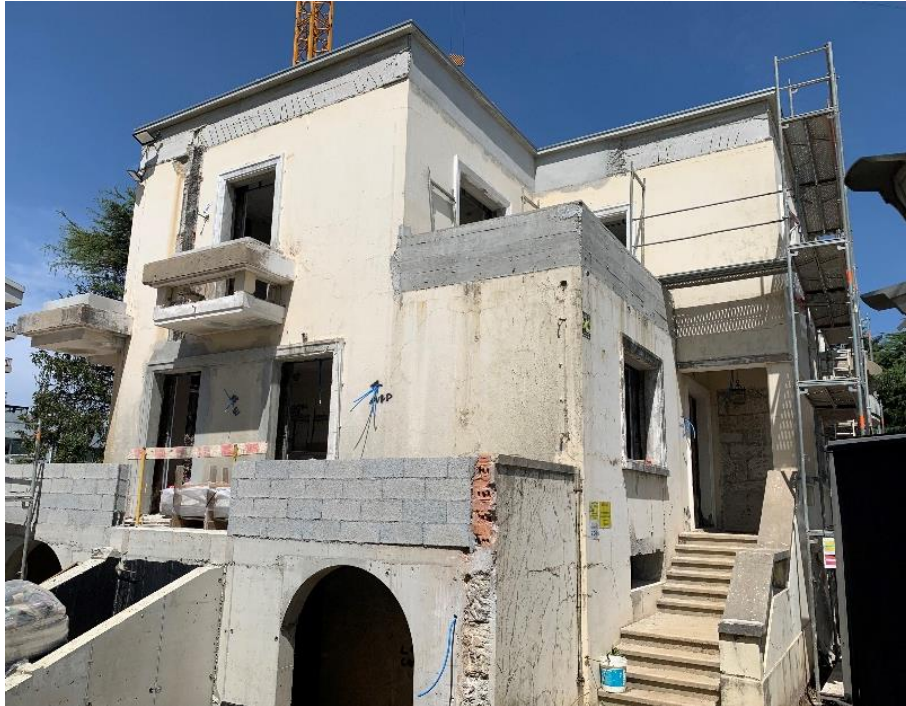
Figura 4-43 – Fachada antes do preenchimento de fissuras
