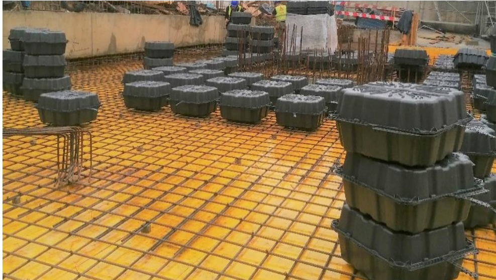
Figura 4-17 – Colocação dos módulos de “Nautilus” de uma laje fungiforme aligeirada com moldes perdidos (Extraído de: Telhabel, 2023b)
