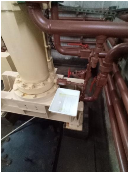
Figura 28 - Grupo de Circulação à saída do Servomotor (Fonte: Navipa)
