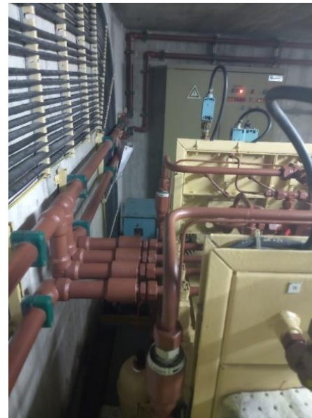
Figura 27 - Grupo de Circuito à saída da Unidade Energética (Fonte: Navipa)
