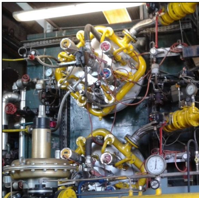
Figura 3.1 - Queimador misto da caldeira 1 da RCOG.
