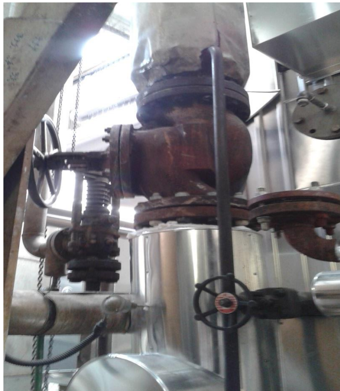
Figura L.1 - Válvula de vapor.
