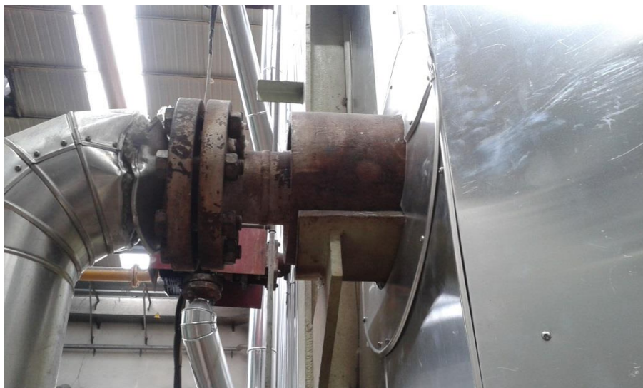
Figura L.4 - Extremidade do tubo da água no economizador.
