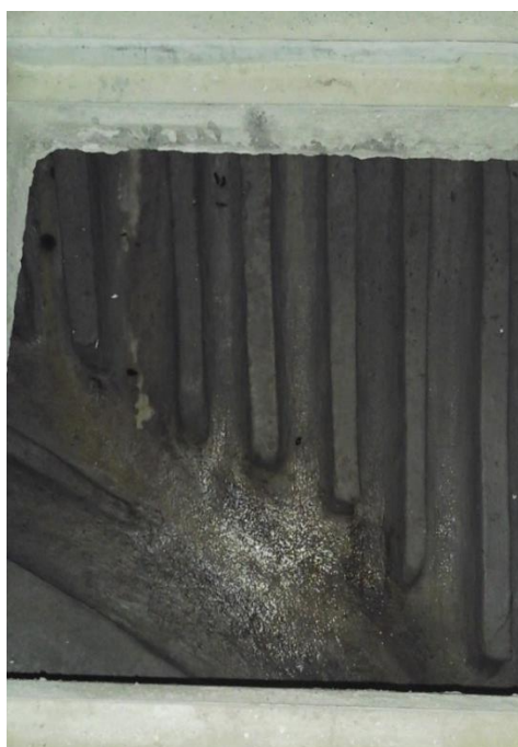
Figura 3.53– Deficiente execução da disposição das caneluras em câmara de visita.
