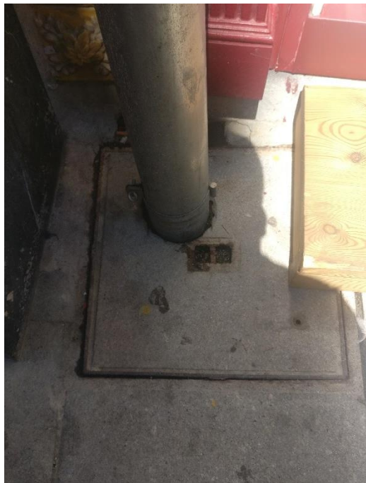
b) Deficiente execução de ligação de tubo de queda à câmara de águas pluviais.
