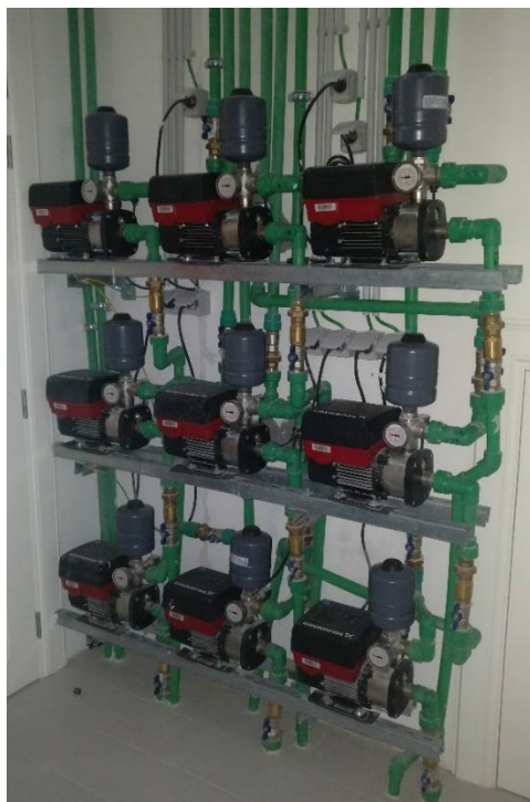
Figura 3.15 – Grupo de bombas em linha.
