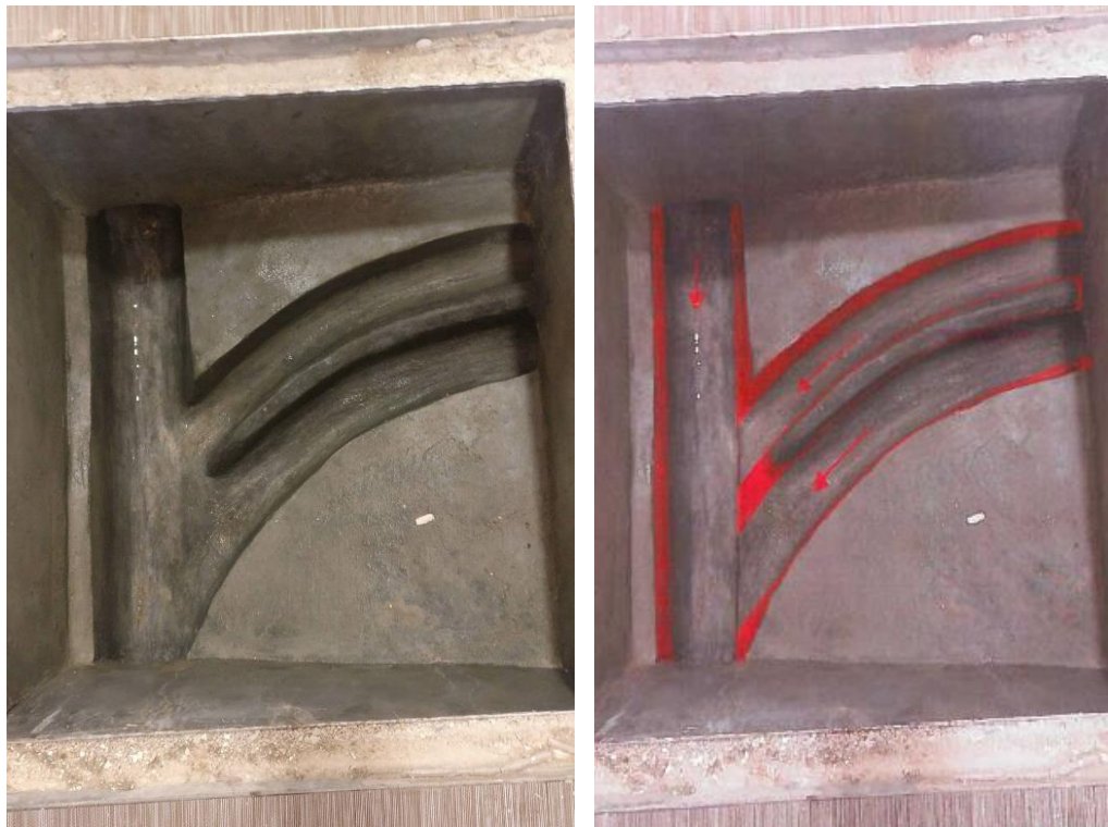
a) Deficiente execução de caneluras em câmara de visita.
