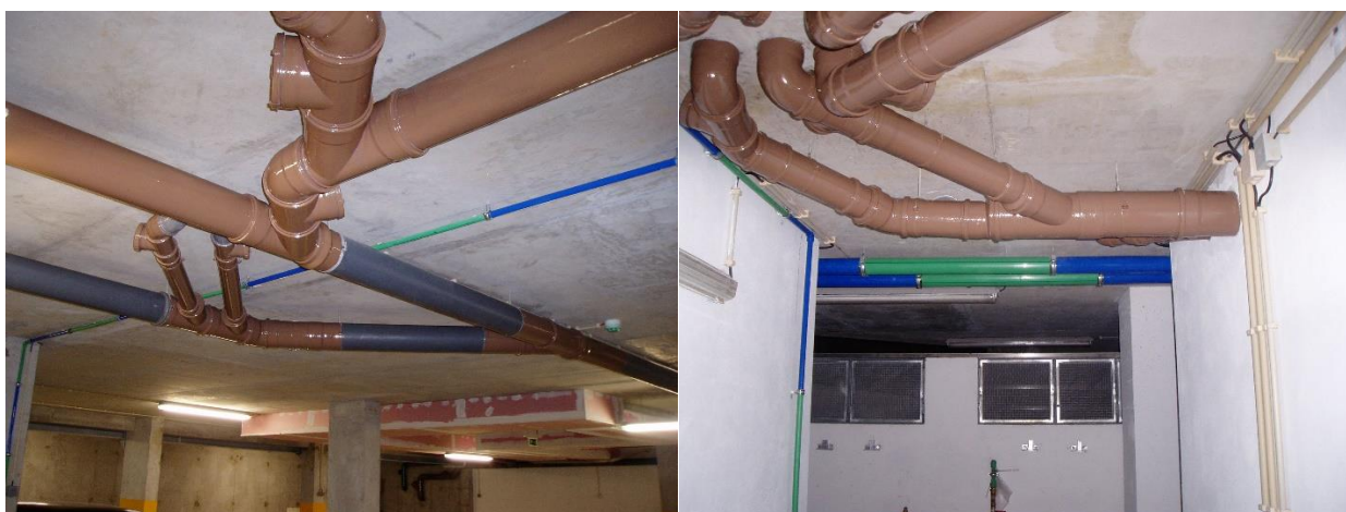
a) Canalização de águas residuais domésticas não conforme NP 182.
