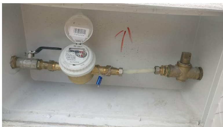
Figura 3.44– Exemplo de nicho com contador e selado pela Águas do Porto.
