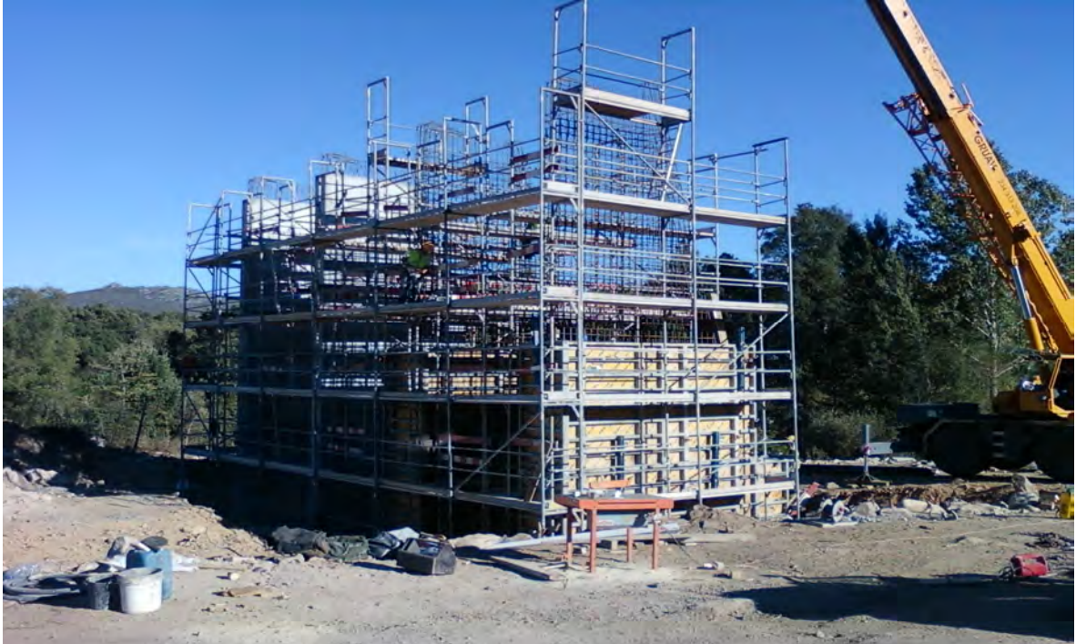
Figura 3.8 – Execução de encontros na Ponte sobre a Ribeira de Santa Comba de Rossas
