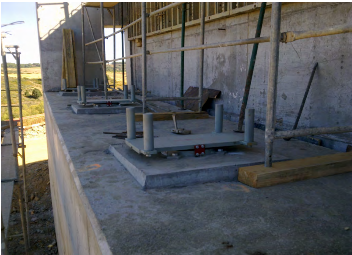
Figura 3.11 – Colocação de aparelhos de apoio no encontro da Ponte sobre o Rio Azibo
