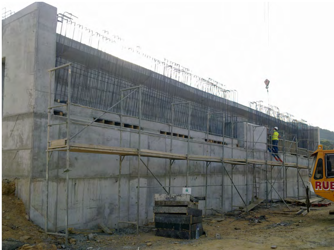
Figura 3.16 – Execução da 1.ª Fase da carlinga no encontro da Ponte sobre o Rio Azibo.
