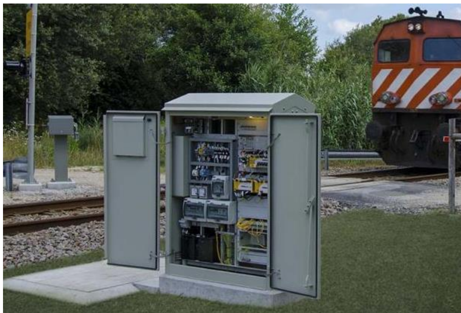
Figura 5 – Armário de controlo implementado na solução XSafe, desenvolvido pela EFACEC [20].
