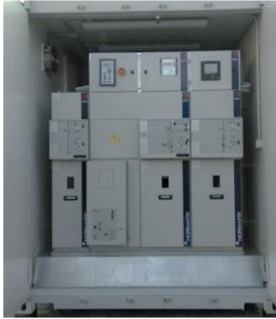
Figura 12- Celas MT 15 kV do PCS block[13]
