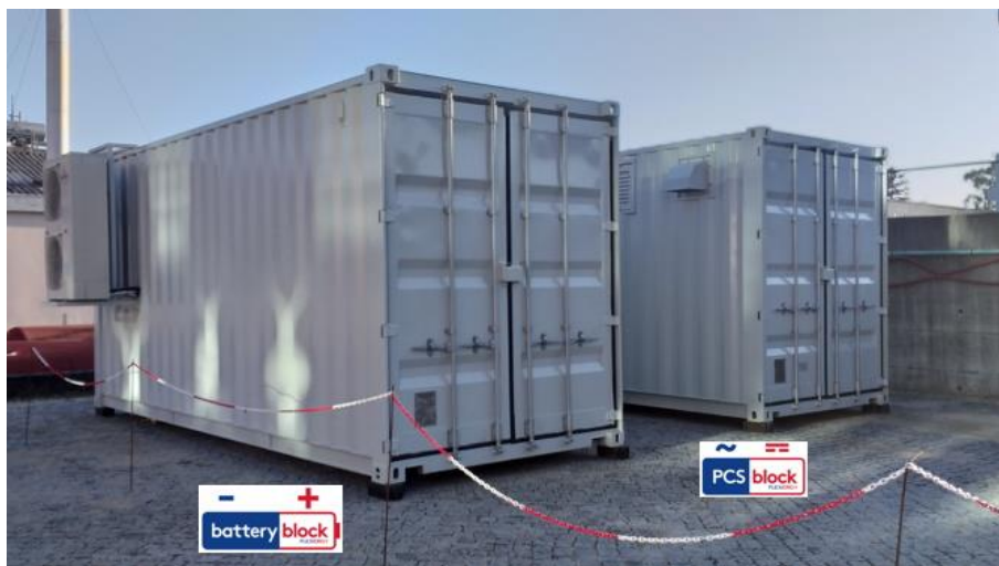
Figura 9-Unidades contentorizadas Battery Block + PCS Block [13]
