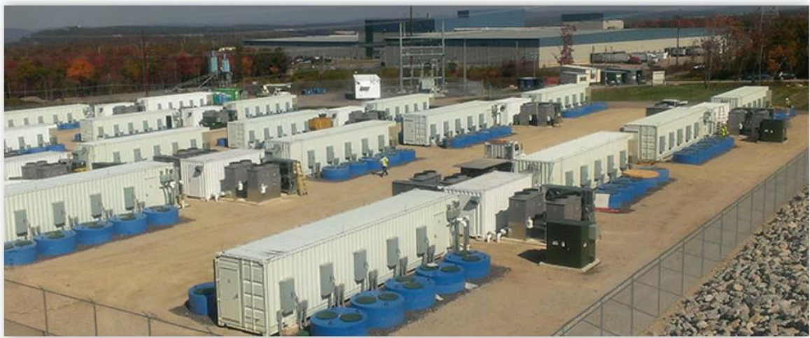
Figura 7-Sistema FESS 20 MW em Hazle Township, Pensilvania[10]
