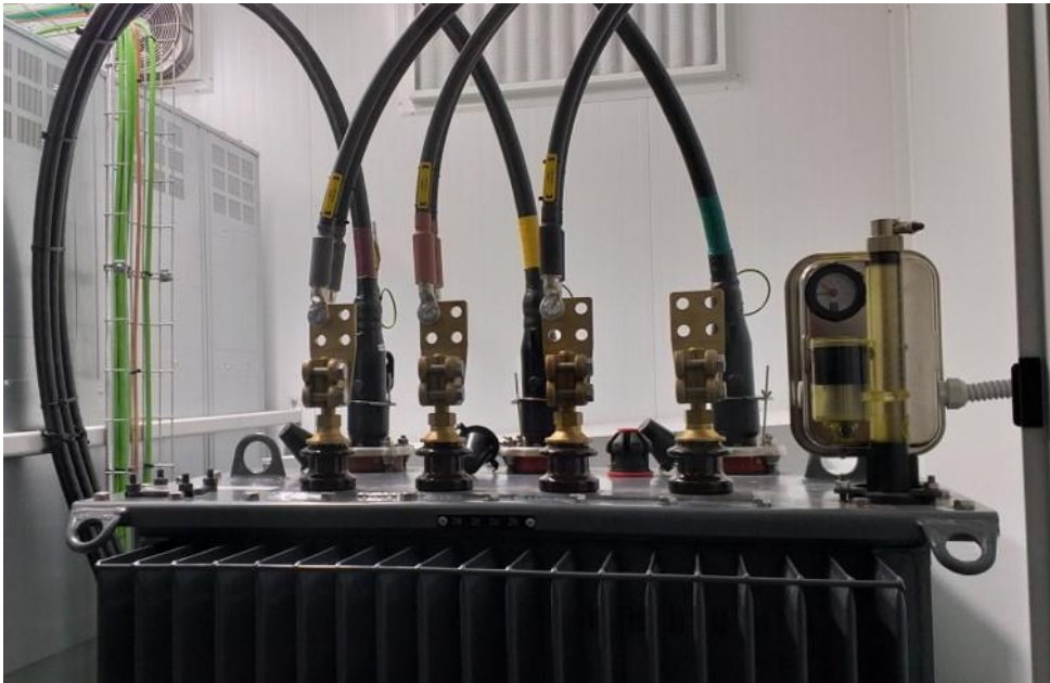
Figura 13- Transformador elevador (MT/BT) 15 kV/ 400 V [13]
