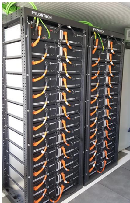
Rack de baterias
