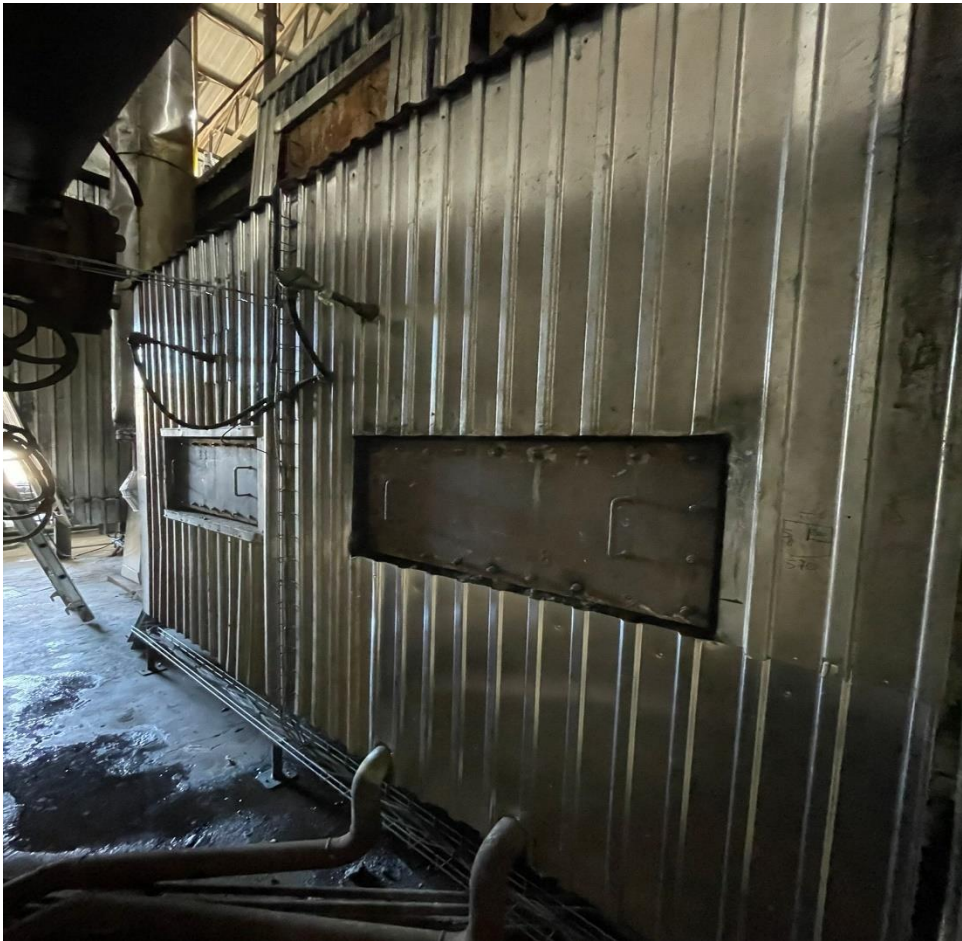
Figura 3.2 - Sobreaquecedor da Caldeira 1 na RAR Cogeração
