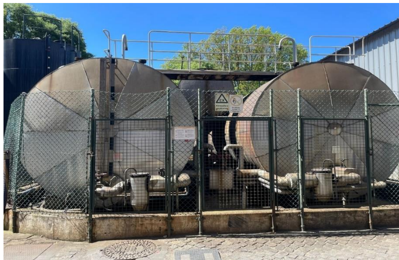
Figura 2.2 - Tanques de armazenamento de Fuelóleo nº4
