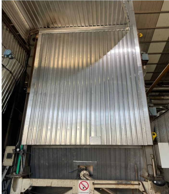
Figura 3.3 - Economizador da Caldeira 1
