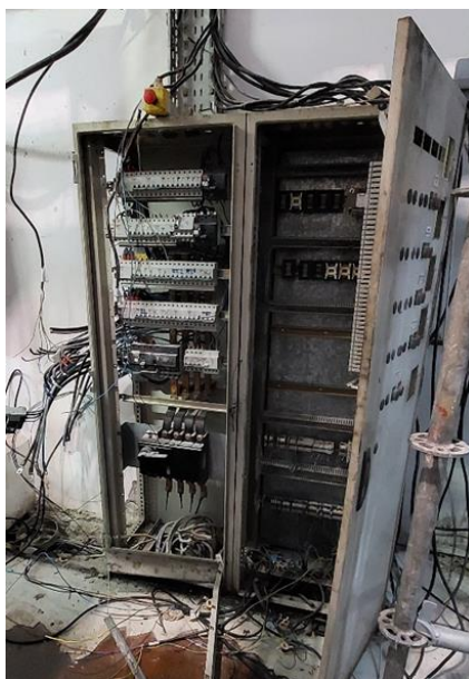
Figura 37 - Quadro elétrico antigo
