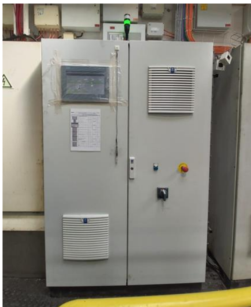
Figura 38 - Quadro elétrico novo
