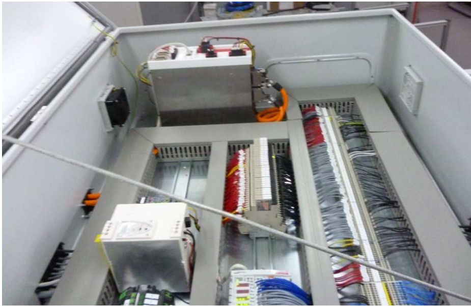
Figura 136 - Ligação de quadro elétrico
