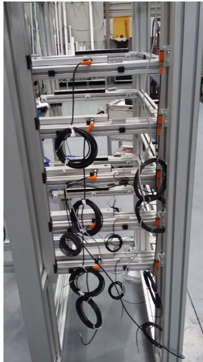
Figura 134 - Aspeto da instalação de ligação de sensores
