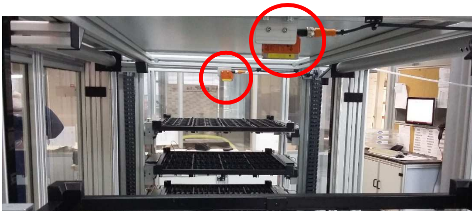
Figura 125 - Instalação de fotocélulas no nível superior
