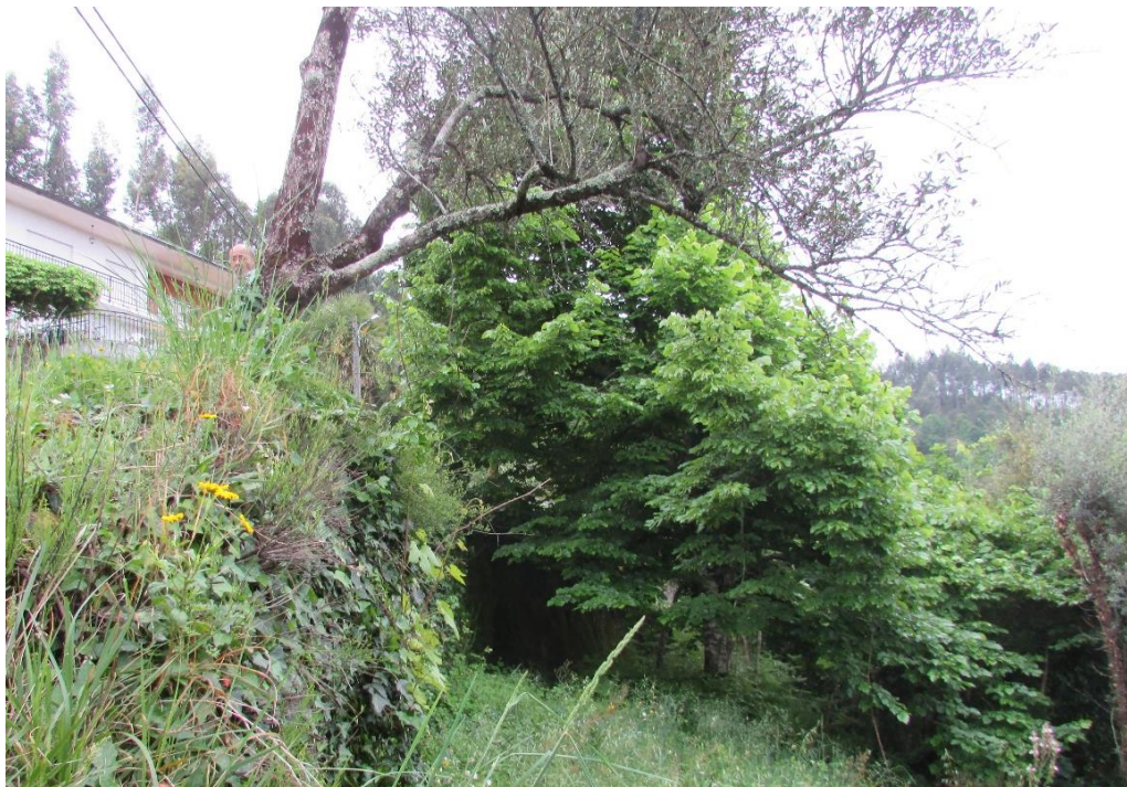
Figura 4-6 – Crescimento de um sobreiro sobre o topo de um muro de alvenaria em pedra xistosa.
