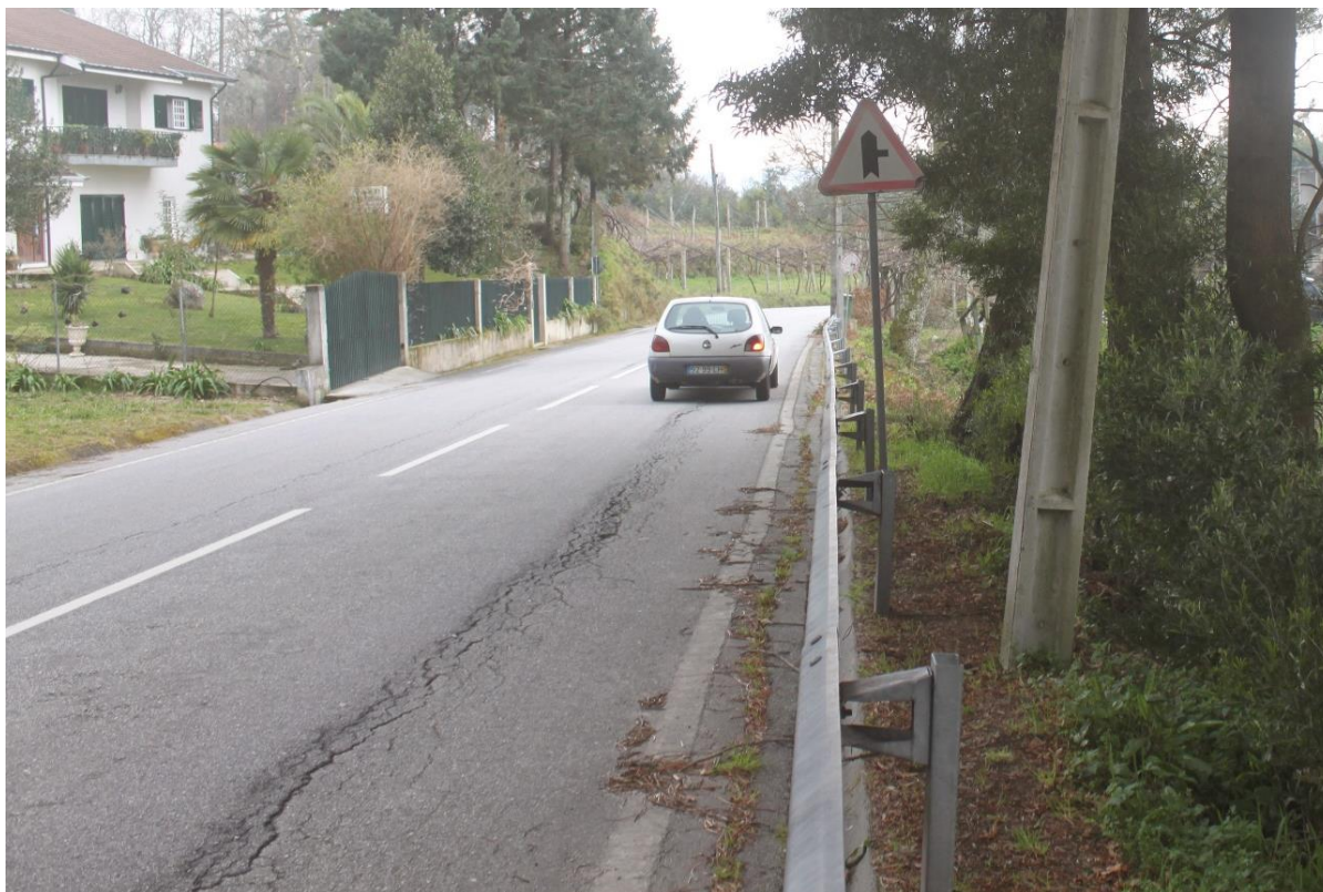
Figura 3-18 – Fissuração e abatimento do pavimento, indiciando um deslizamento do talude a jusante da via. Rua de Manhufe, Mancelos. (Caso 23.01)
