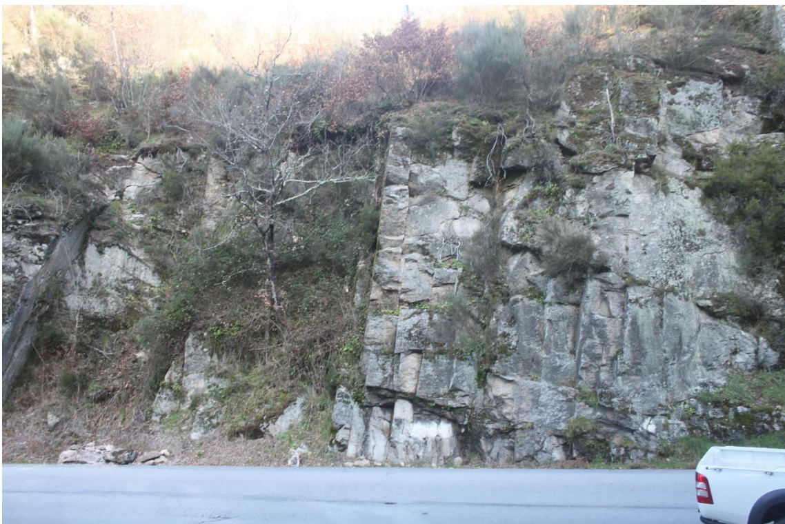
Figura 3-7 – Local propício a quedas de rochas, Rua Central de Ansiães (Caso 03.03)
