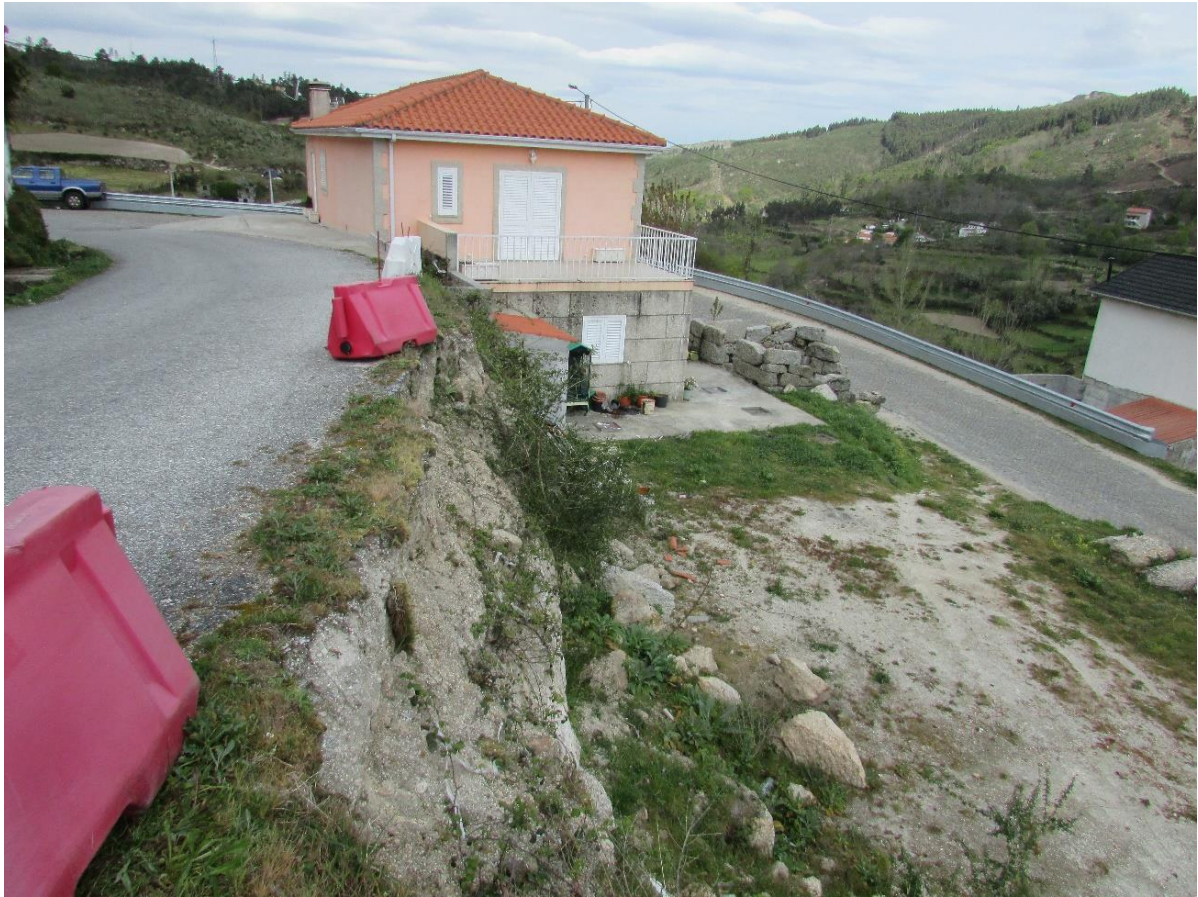
Figura 3-16 – Talude terroso com inclinação quase vertical. Rua Marquês de Pombal, Carneiro. (Caso 08.01)
