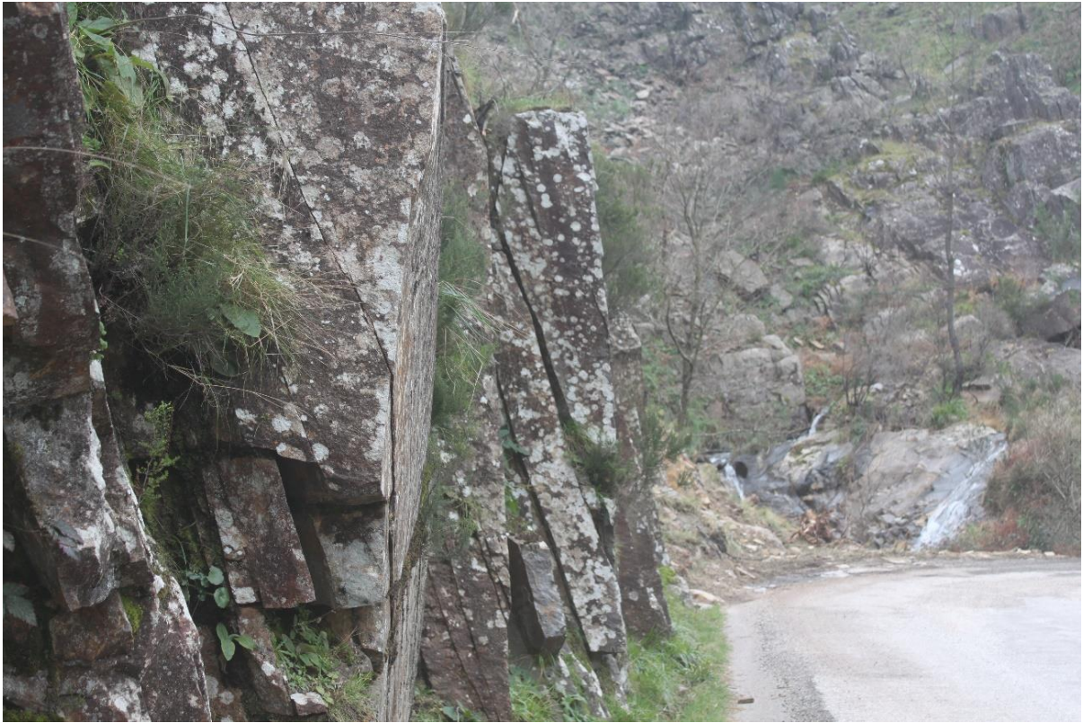
Figura 3-19 – Identificação de porções do maciço que podem sofrer quedas ou tombamentos. M574 (Acesso a Covelo do Monte), Aboadela. (Caso 01.01)
