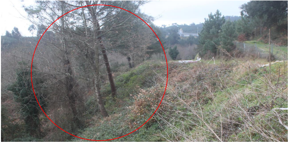
Figura 3-4 – Elementos inclinados no corpo do talude evidenciando um escorregamento lento, Rua das Macieiras, Fregim (Caso 12.01)
