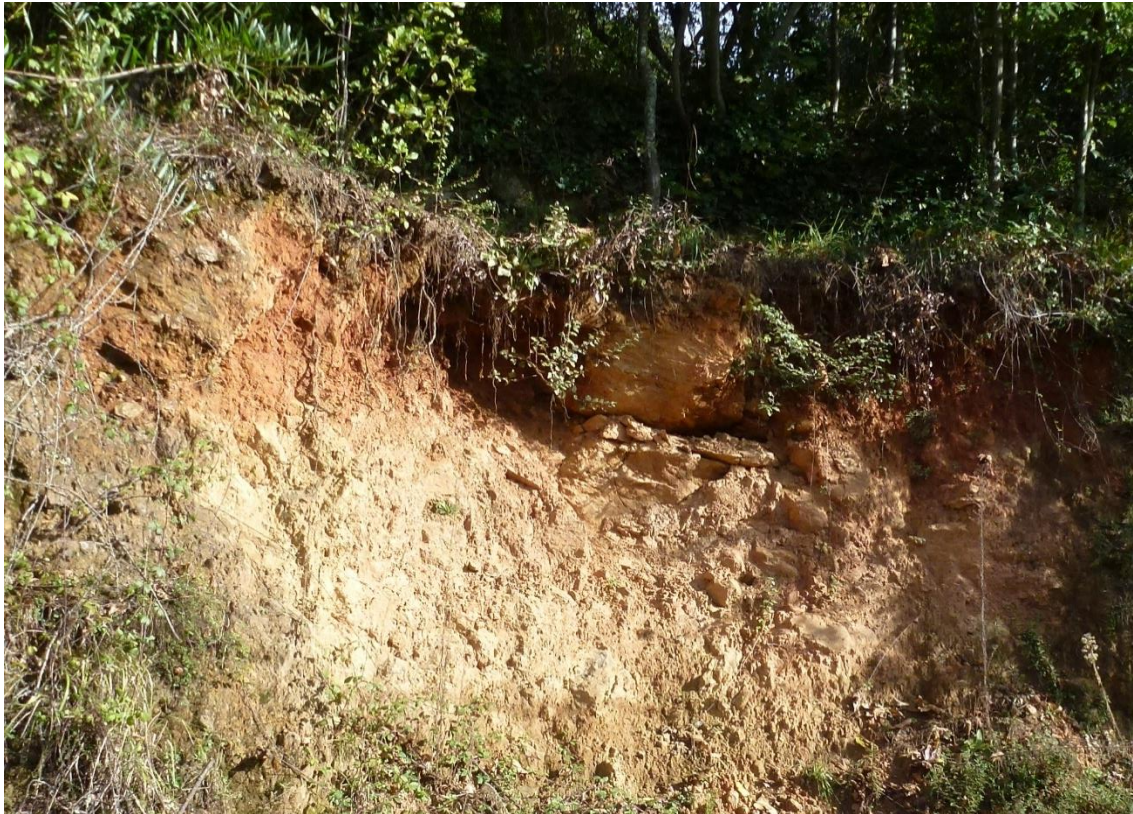
Figura 3-9 – Instabilização do talude provocada pela desumidificação do maciço argiloso, Rua Central de Canadelo, Talude da Charola (Caso 06.01)
