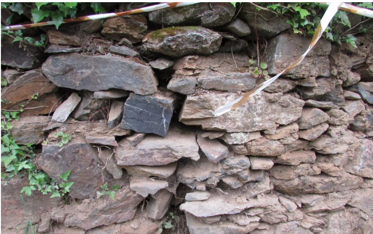
Figura 4-7 – Abertura de juntas devido a deformação horizontal do muro. Rua de Lamelas, Rebordelo. (Caso 28.12)
