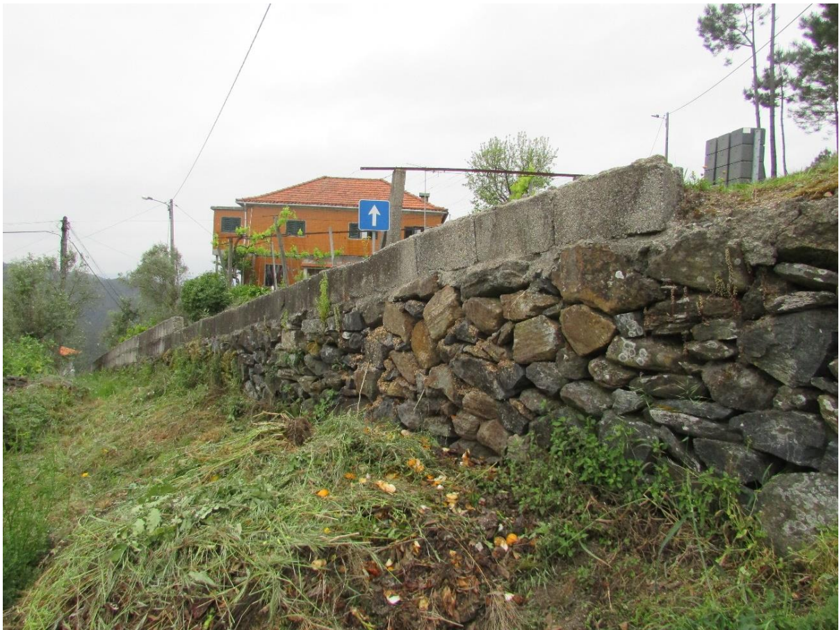
Figura 4-3 – Muro de contenção em alvenaria de pedra xistosa. Rua da Portela, Rebordelo. (Caso 28.02)
