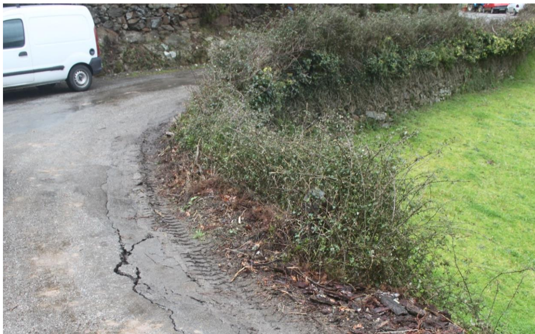
Figura 4-8 - Fissuração e abatimento do pavimento a montante de um muro de suporte. Rua da Eira de Covelo, Aboadela. (Caso 01.08)
