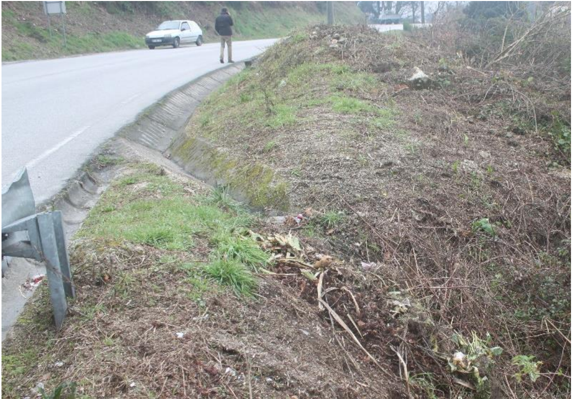
Figura 3-15 – Exemplo de um erro de conceção, descarga da valeta sob o talude. Rua das Golas, Amarante – S. Gonçalo, (Caso33.01)
