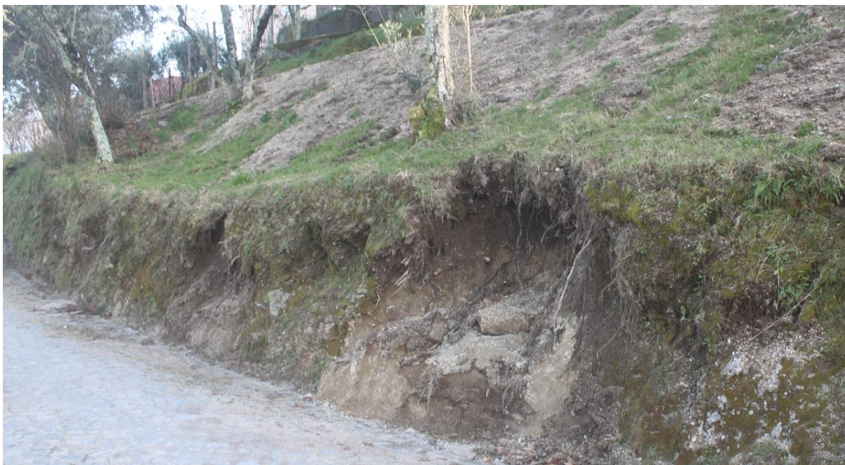
Figura 3-5 – Exemplo de um corte do pé do talude, Rua de Gavim, Bustelo (Caso 05.01)
