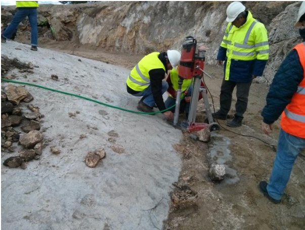
FIGURA 5.87 - INSPECÇÃO DO ESTADO DO BETÃO AG21, S. GENS (24.03.2015)
