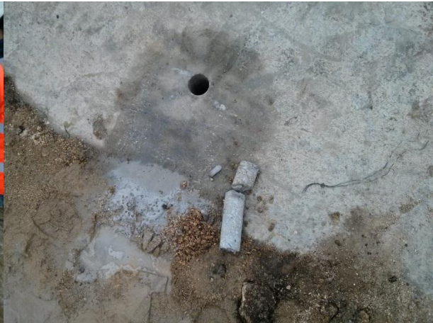
FIGURA 5.88 - INSPECÇÃO DO ESTADO DO BETÃO AG21, S. GENS (24.03.2015)
