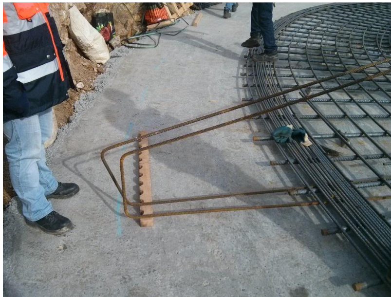
FIGURA 5.66 - VARÃO CONFORME EM 1º PLANO, VARÃO MAL DOBRADO ATRÁS, S. GENS (16.02.2015)
