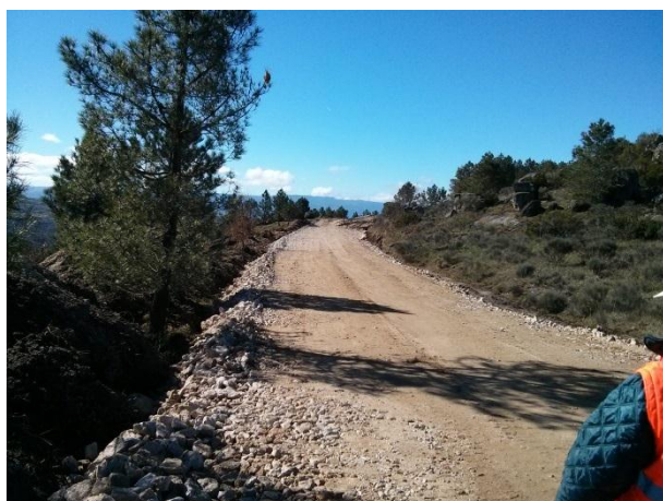
FIGURA 5.106 - ASPECTO DOS ACESSOS SEM ABGE A2, PISCO (27.03.2015)
