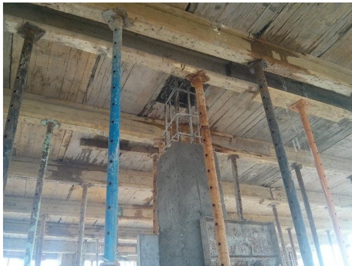
FIGURA 5.136 - PILAR MAL BETONADO SUBESTAÇÃO, PISCO (19.05.2015)
