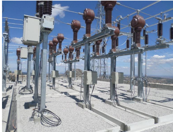
FIGURA 5.158 - PARQUE EXTERIOR SUBESTAÇÃO, PISCO (18.07.2015)
