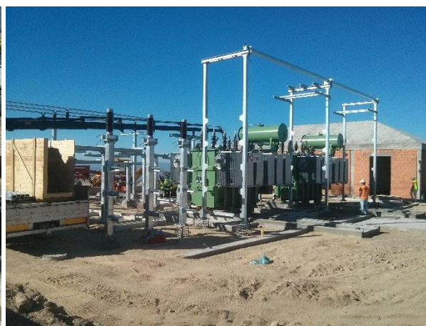
FIGURA 5.154 - TRANSFORMADORES DE POTÊNCIA (TR) SUBESTAÇÃO, PISCO (17.06.2015)
