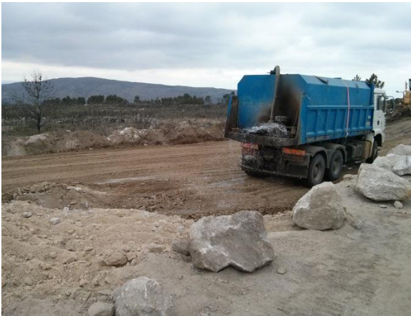
FIGURA 5.36 - ESPALHAMENTO DE ÁGUA EM ATERRO, S. GENS (17.03.2015)
