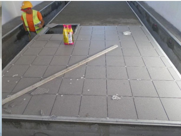
FIGURA 5.142 - ASSENTAMENTO DO PAVIMENTO SUBESTAÇÃO, PISCO (18.06.20015)
