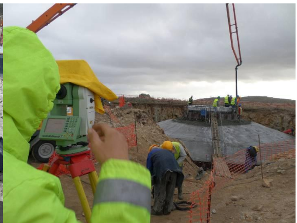
FIGURA 5.78 - VERIFICAÇÃO DOS PERNOS AG9, S. GENS (24.02.2015)
