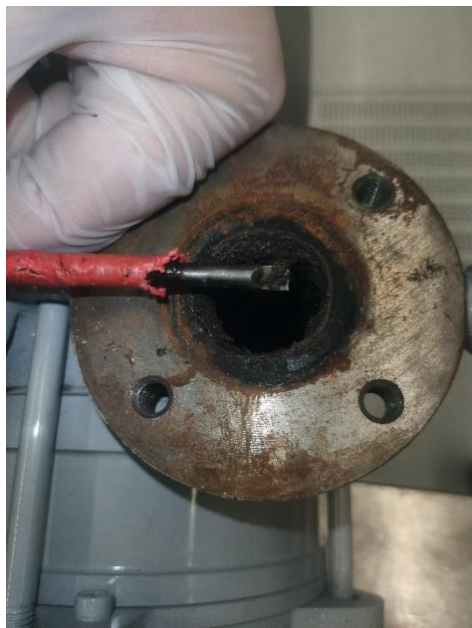
Figura 17 - Detritos metálicos provenientes do interior da bomba
