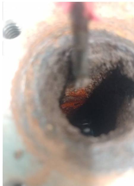
Figura 18 - Detritos metálicos e oxidação do interior da bomba
