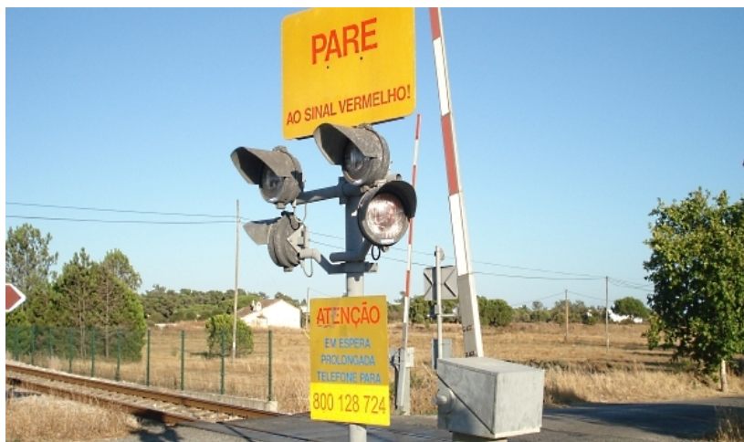
Figura 18 - Sistema de PN, com barreira de secções retangulares de alumínio (Infraestruturas de Portugal)
