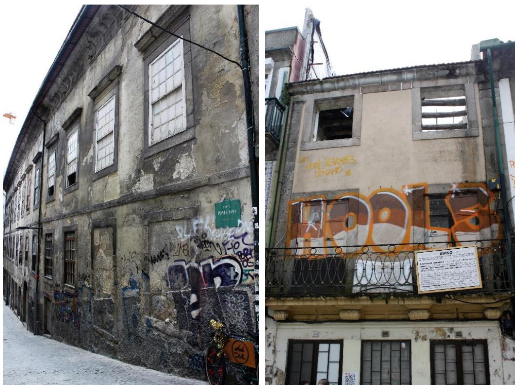
Figura 3.3 – Fachadas com notórias anomalias no Porto (fotos do autor)
