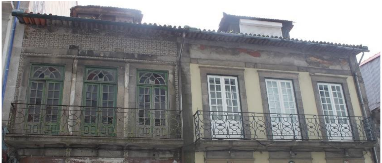
Figura 3.2 – Edifícios com notórias anomalias na Rua do Bonjardim (foto do autor)
