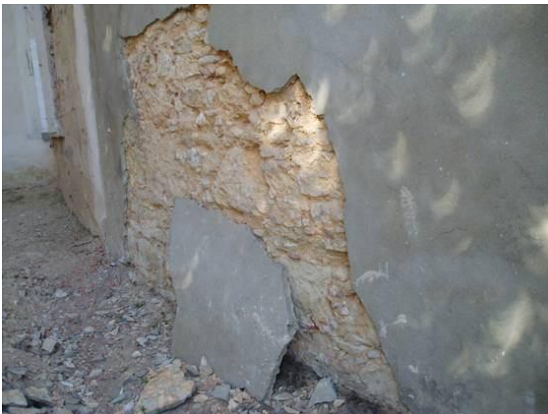
Figura 3.14 – Destacamento localizado de reboco [14]
