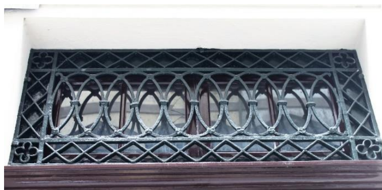
Figura 2.10 – Grade de ferro de bandeira de porta no Porto (foto do autor)
