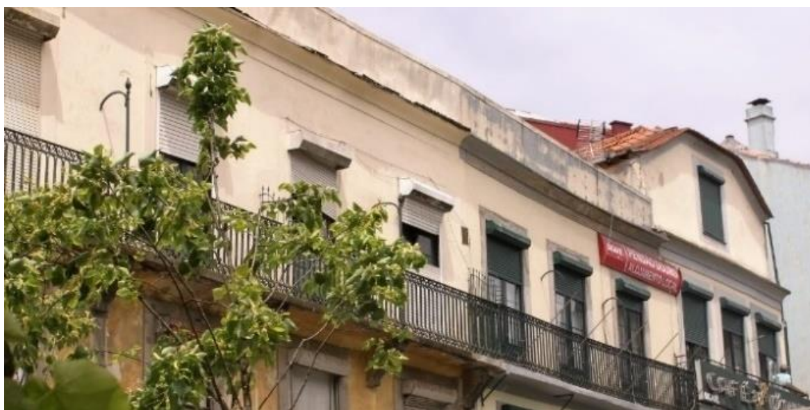
Figura 3.6 – Fachada danificada por problemas relacionados com humidade perto do Café do Piolho no Porto (foto do autor)
