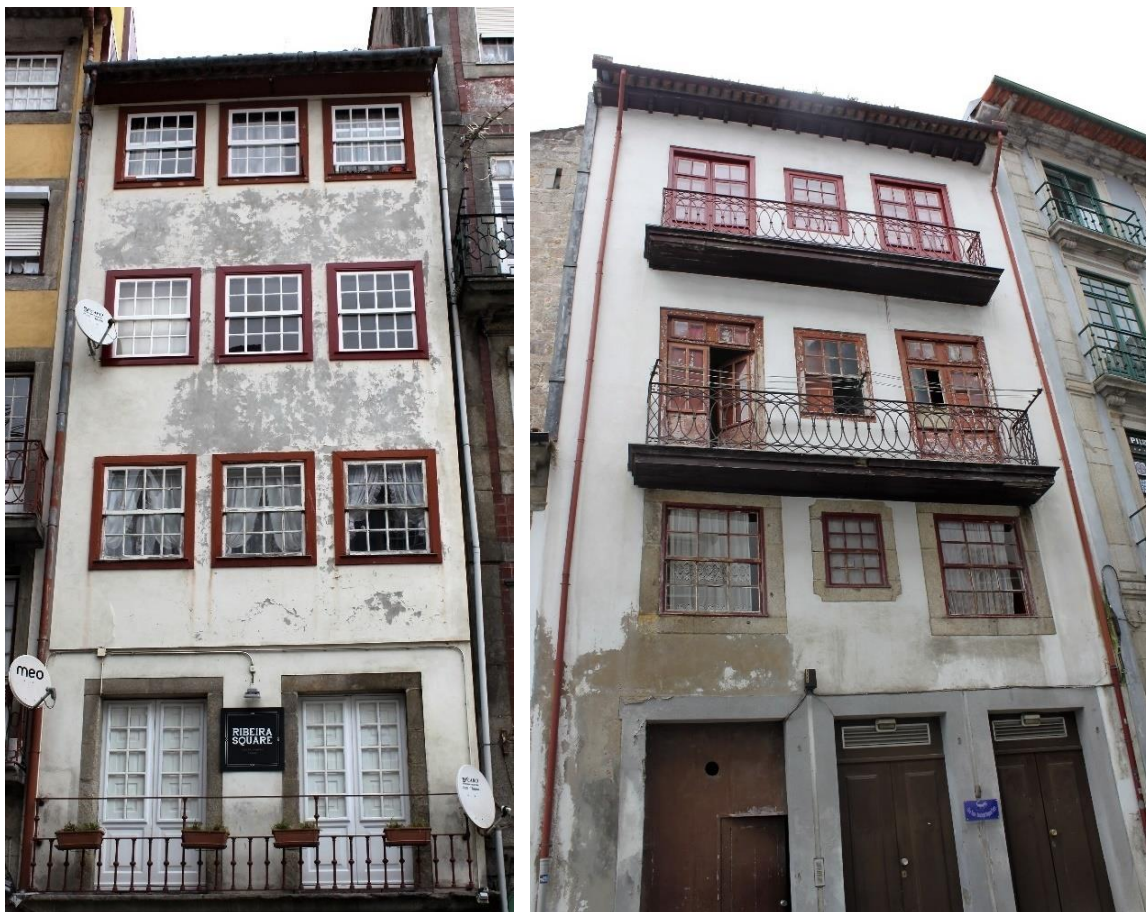
Figura 3.15 – Anomalias em pinturas em edifícios situados na Ribeira (fotos do autor)
