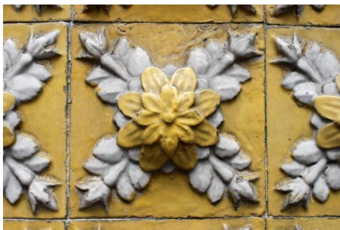
Figura 2.6 – Revestimento exterior em azulejo na Rua Mouzinho de Silveira (foto do autor)
