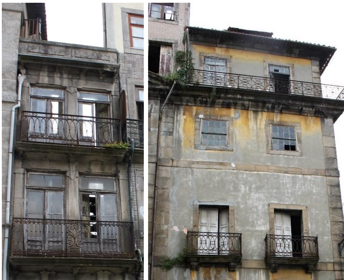
Figura 3.11 – Fachadas com anomalias em elementos secundários (fotos do autor)
