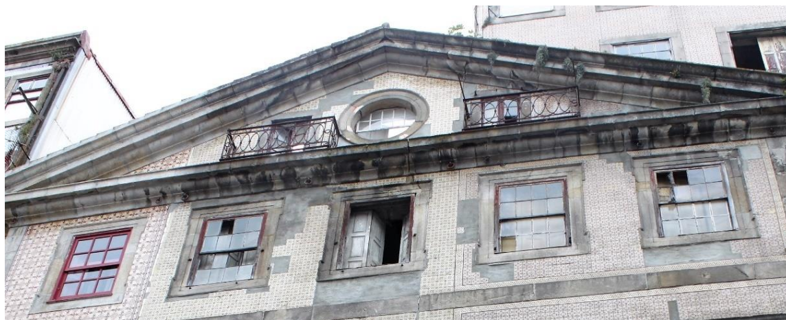
Figura 3.10 – Janelas com anomalias na Rua Mouzinho da Silveira (foto do autor)
