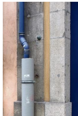
Figura 4.10 – Tubo de queda protegido (foto do autor)
