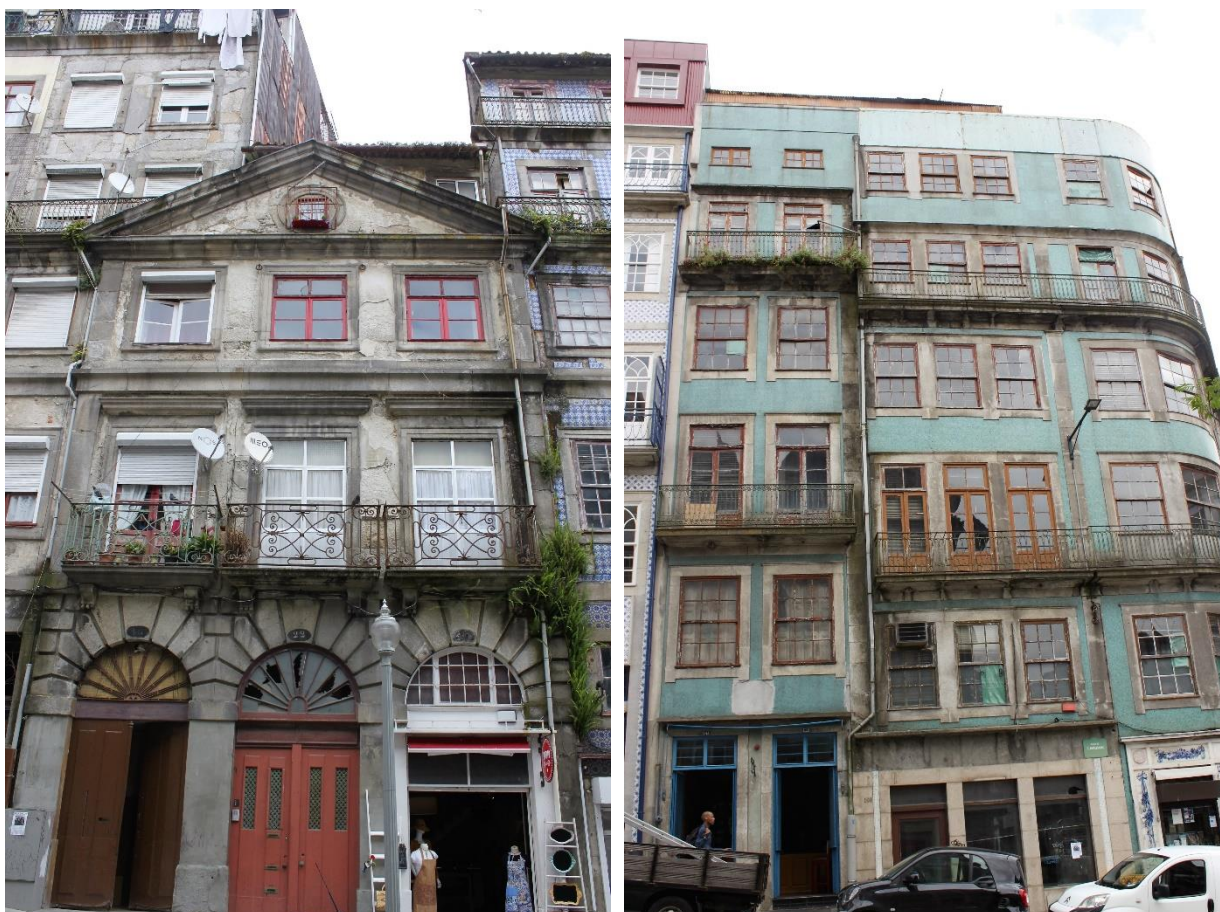
Figura 3.7 – Fachadas de edifícios antigos variadas anomalias (fotos do autor)
