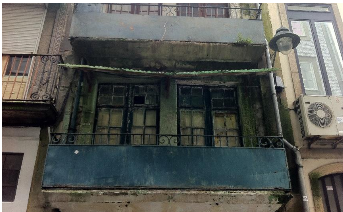
Figura 3.1 – Fachada com amplas anomalias na Rua do Comércio do Porto (foto do autor)
