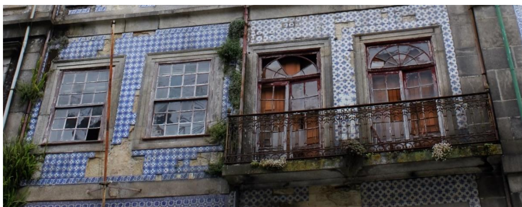
Figura 3.9 – Janelas com anomalias na Rua de S. João (foto do autor)
