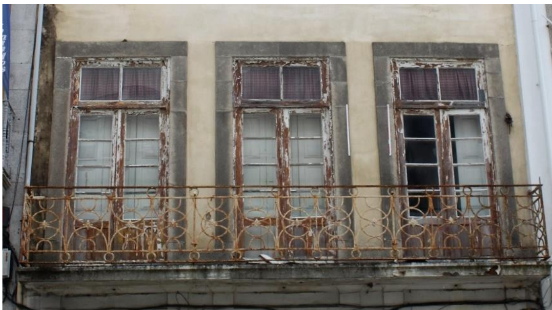
Figura 3.5 – Janelas e guarda com oxidação das peças metálicas (foto do autor)
