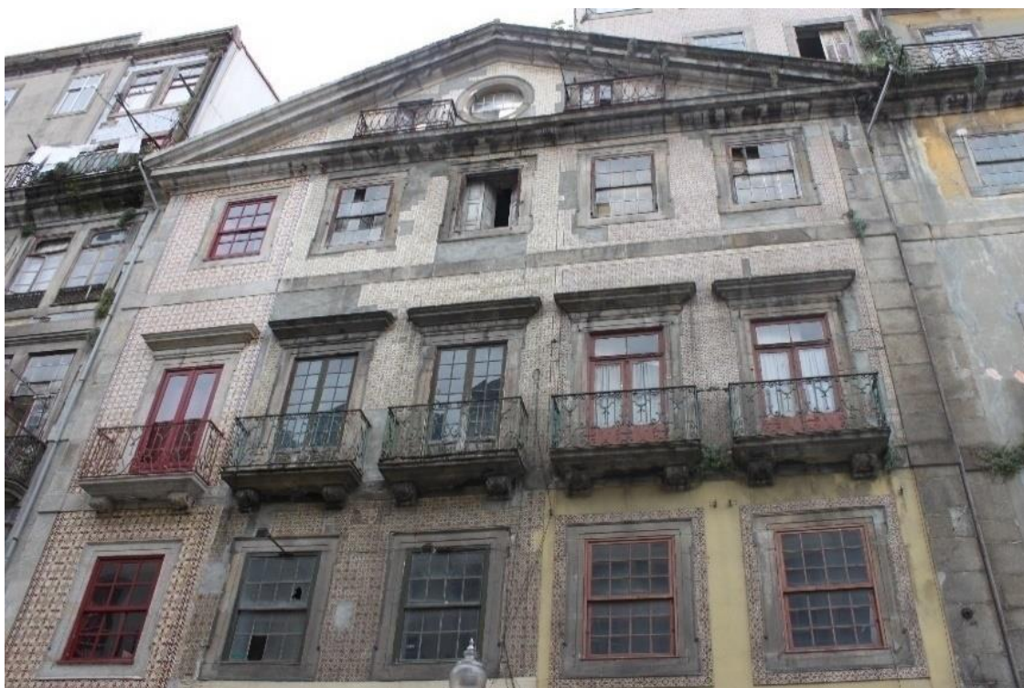
Figura 3.13 – Fachada com variadas anomalias na Rua de S. João (foto do autor)
