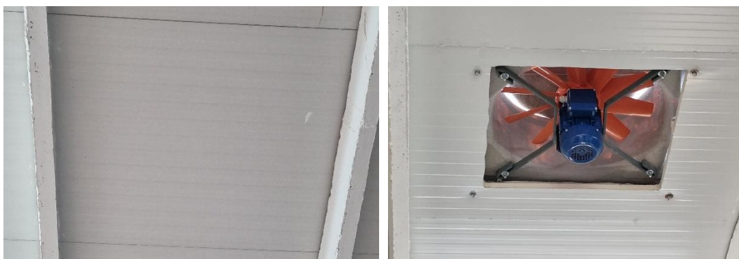
Figura 35 – Antes e depois da aplicação de um ventilador-extrator.
