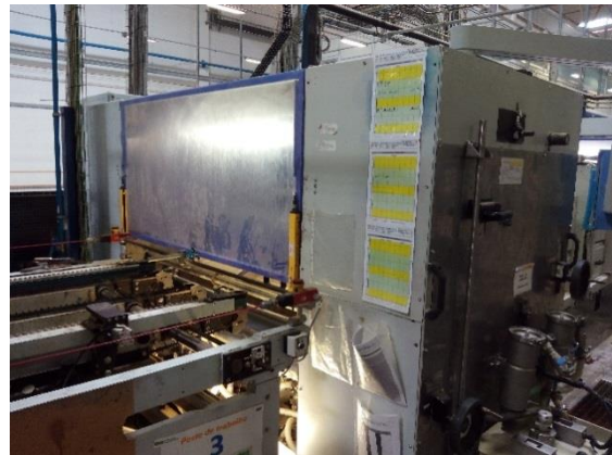
Figura 23 - Cabine da aplicação da cola
