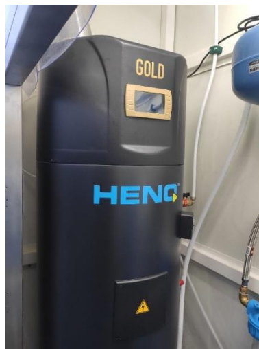
Figura 13 - Bomba de calor.
