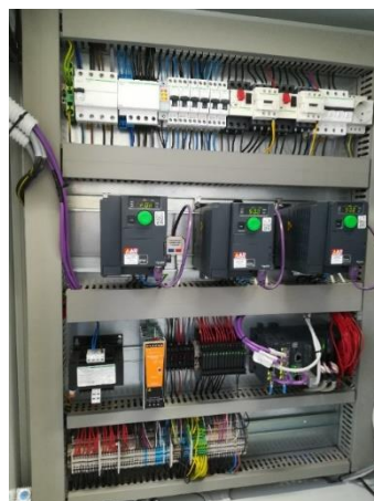
Figura 15 - Exemplo de quadro elétrico
