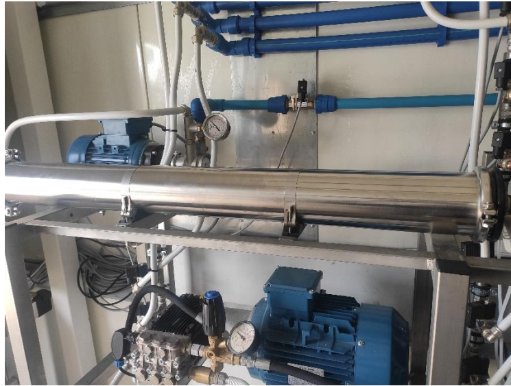
Figura 14 – Membrana de osmose inversa
