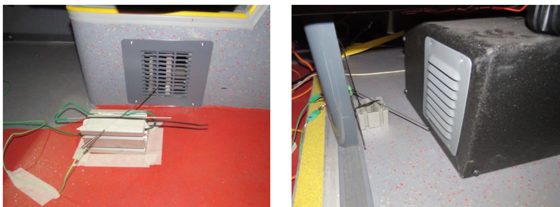
Figura 83 Saída de ventilação frontal e traseira do salão com sensores de temperatura
