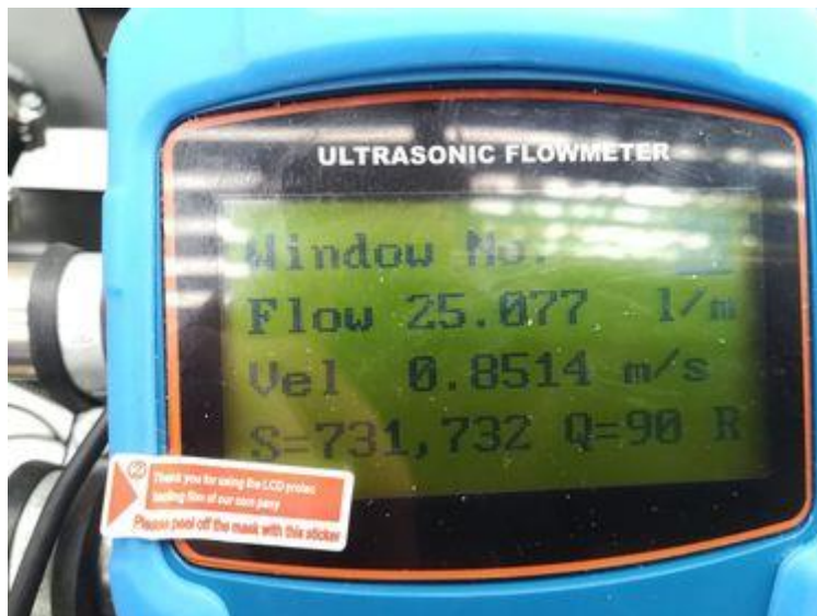
Figura 59 Teste ao caudal do sistema de aquecimento
