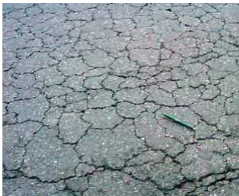
Figura 3.6 – Patologia tipo "Pele de crocodilo" devido às ações climáticas e perda de flexibilidade do betume (Ipe.ws, 2017)
