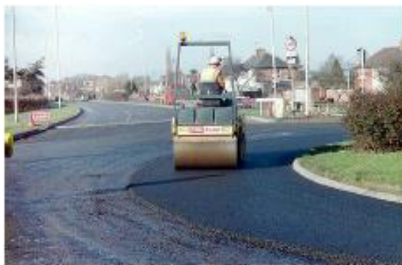
Figura 2.14 – Aplicação de um pavimento SMA em estradas de médio tráfego (Highways maintenance,2009)
