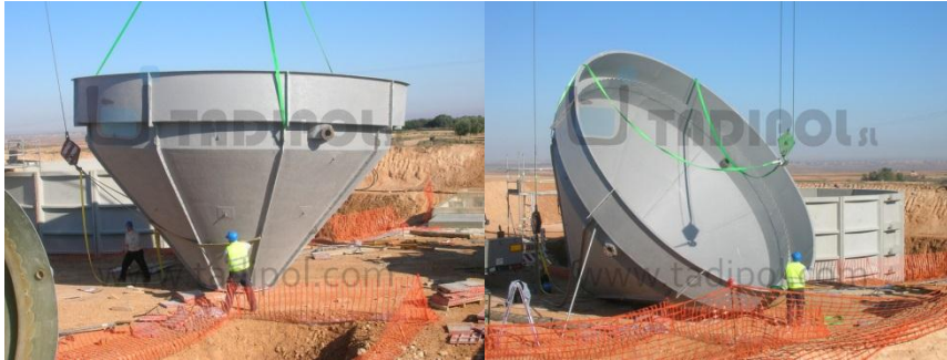
Figura 4.17 – Decantador em PRFV
