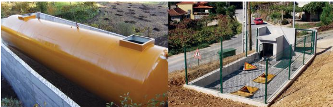
Figura 4.3 – ETAR compacta subterrânea e respetiva vista exterior [30]
