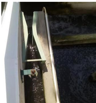
Figura 4.12 – Medidor de caudal tipo Parshall
