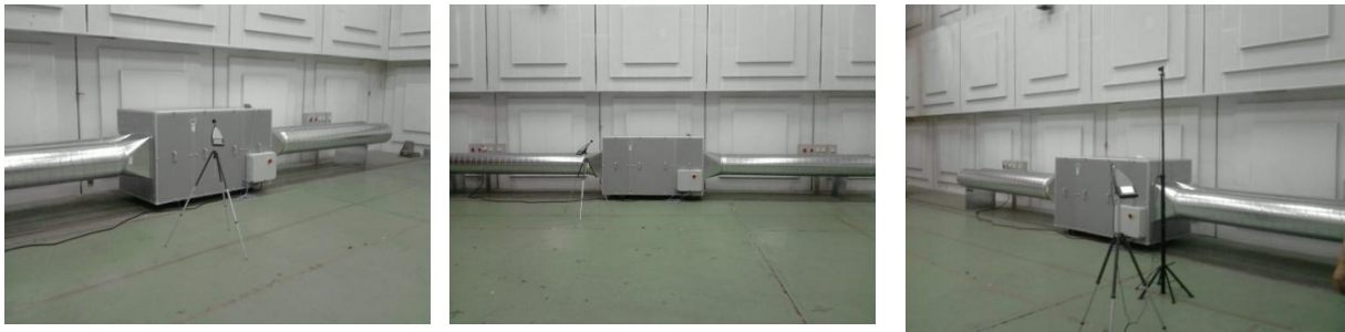
Figura C.1 -Instalação de um sistema de exaustão, para ensaios da determinação de potência sonora
