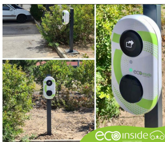
Figura 10 - Instalação de sistemas de carregamento para carros elétricos pela Ecoinside
