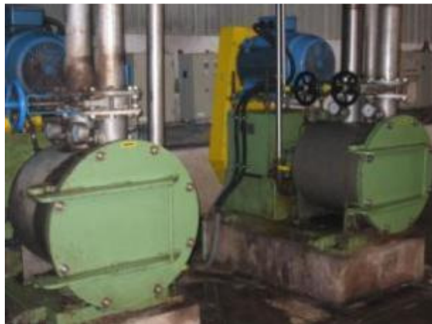
Figura 4.7 – Depuradores CH5 da Ponte Redonda
