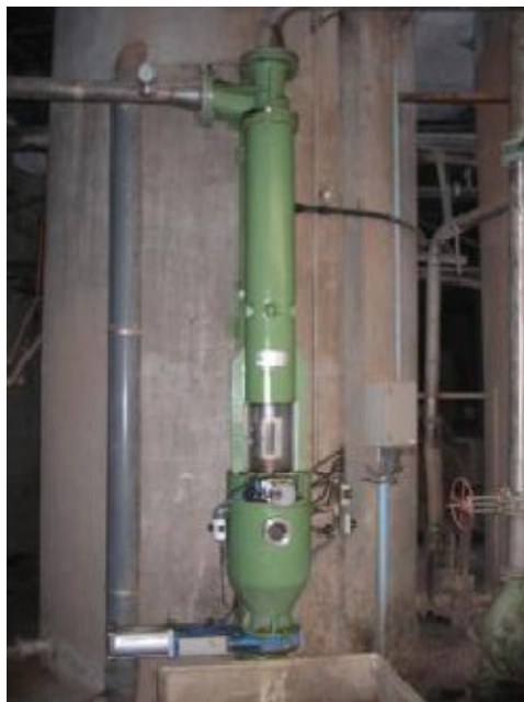
Figura 4.5 – Depurador ciclónico de pasta grossa da Ponte Redonda
