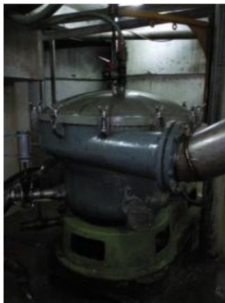
Figura 4.10 – Depurador cabeça de máquina da Ponte Redonda
