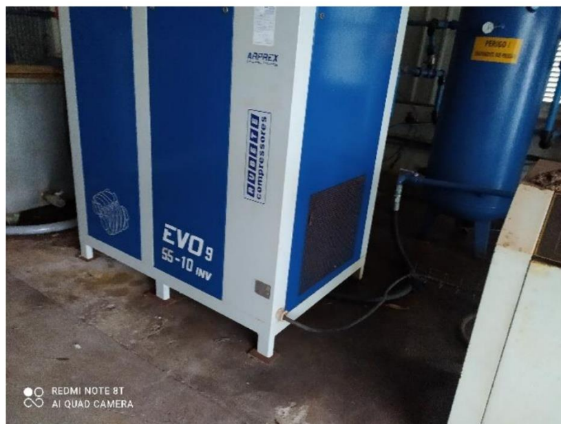
Figura 25-Equipamento de ar comprimido
