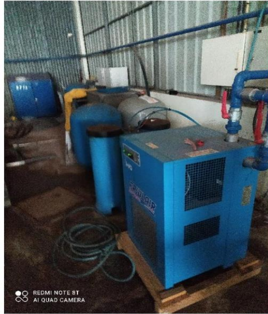
Figura 26-Unidade de secagem do ar comprimido
