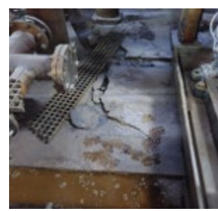
c) Fissuração do pavimento
