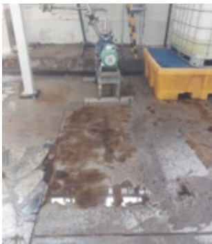
a) Perda de secção do betão
