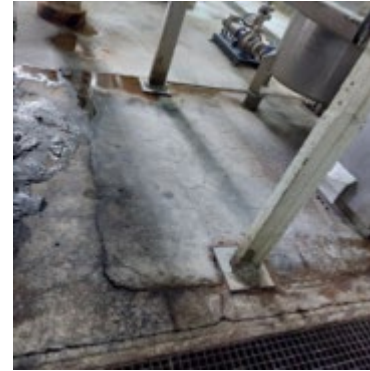
c) Fissuração do pavimento
