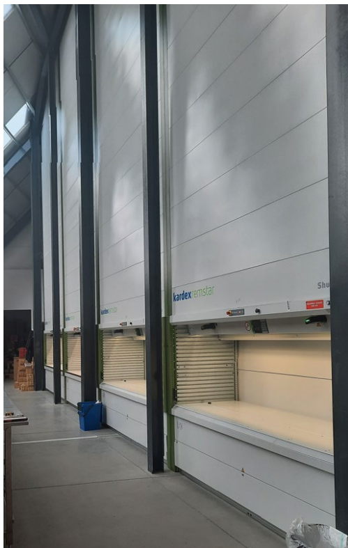
a) Vista da parte inferior do Kardex
