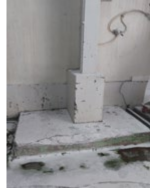
c) Acumulação de resíduos
