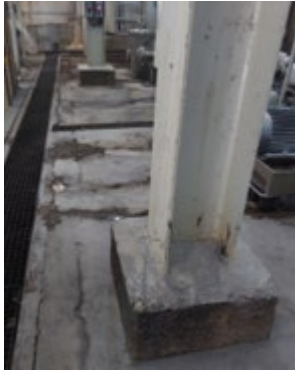
a) Fissuração do pavimento
