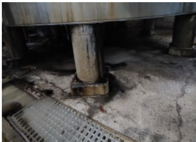
b) Fissuração do pavimento
