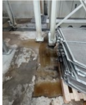
b) Perda de secção do betão
