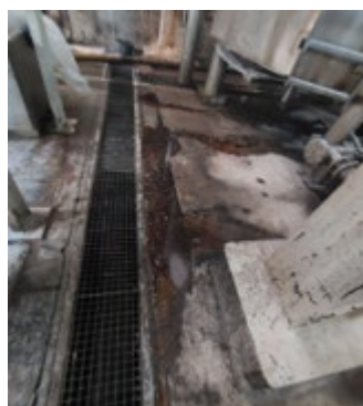
a) Fissuração com perda de secção do pavimento
