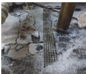
a) Fissuração do pavimento
