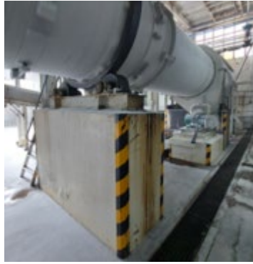
b) Apoios dos equipamentos da refinaria
