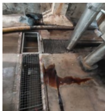
b) Fissuração do pavimento
