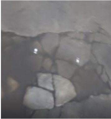
a) Fissuração grave do pavimento
