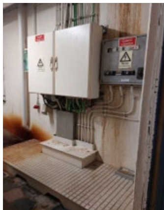
b) Quadro elétrico
