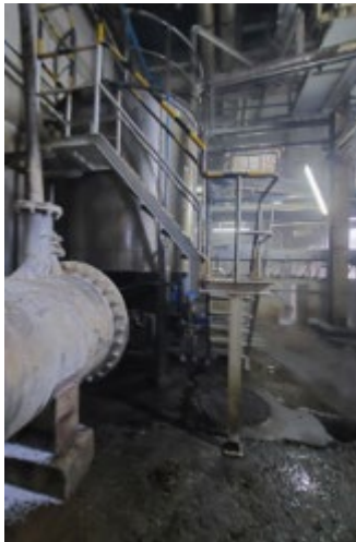
a) Perda de secção do betão
