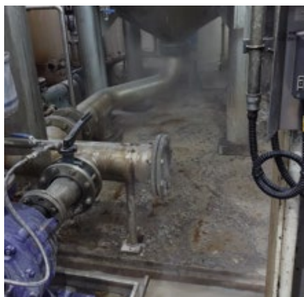
a) Descasque superficial do pavimento
