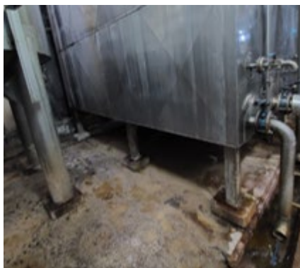
a) Perdas de secção do pavimento
